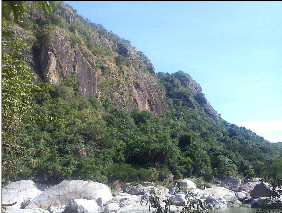
Fotografía 2.4 Falla El Cantil en la ladera de la margen izquierda.
