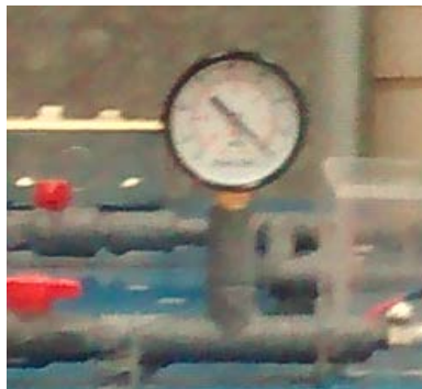
Figura 4.27 Vacuometro instalados en el sistema hidráulico
