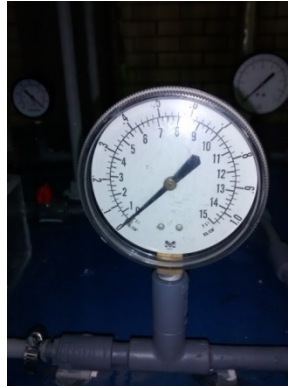
Figura 4.26 Manómetros instalados en el sistema hidráulico
