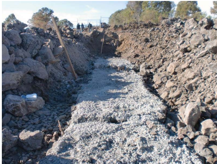
Fotografía 4.4.- Colocación de plantilla del muro a base de concreto pobre. (Fuente: Propia, 2011).
