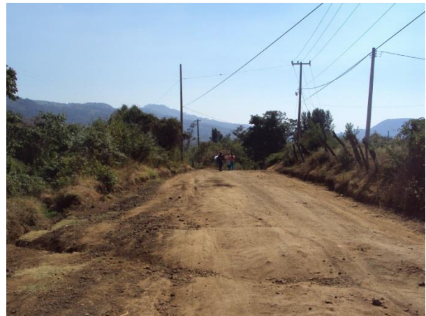
Fotografía 3.2.- Estado actual del camino.
