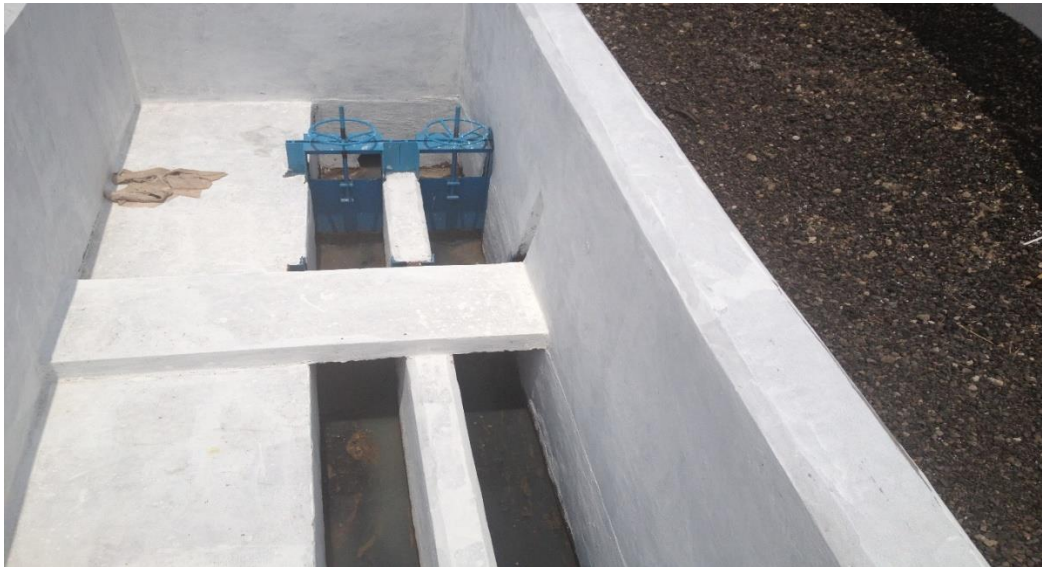
FOTO 6 PLANTA TRATAMIENTO SANTA RITA
