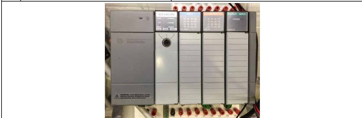
Figura [4.10] Equipo SLC 500 del laboratorio de PLC del CDMIT.
