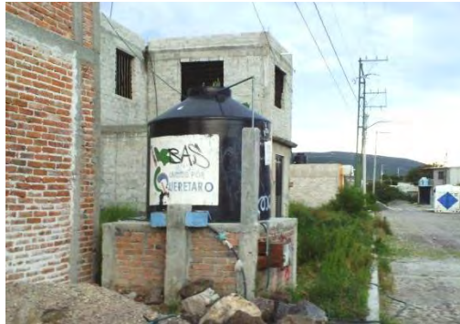
Toma de agua comunitaria en la Colonia Real de España, calle 8
