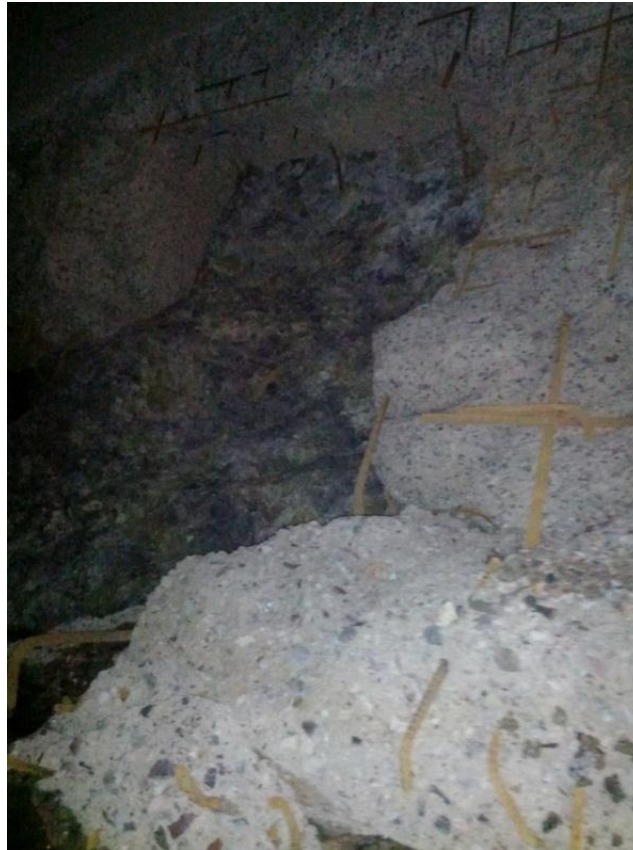
Imagen 6.4.2.1. Vista de un desprendimiento de concreto y varilla en el interior del túnel.
