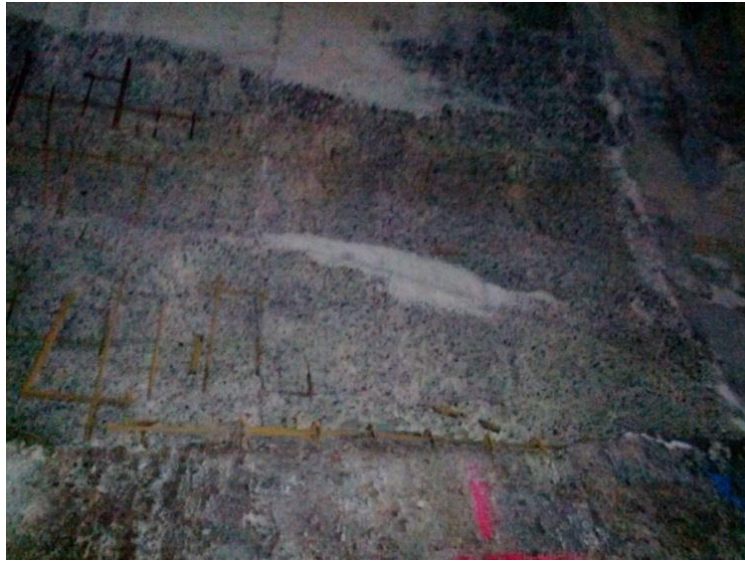
Imagen 6.4.2.2. Vista de los efectos de la erosión del agua, acero expuesto.
