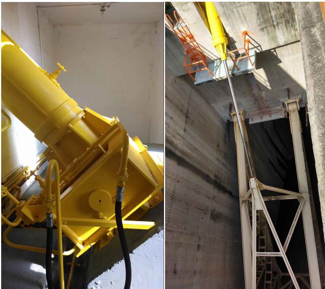
Imagen 6.3.2. Vista del motor hidráulico que impulsa la compuerta y el brazo que la conecta.
