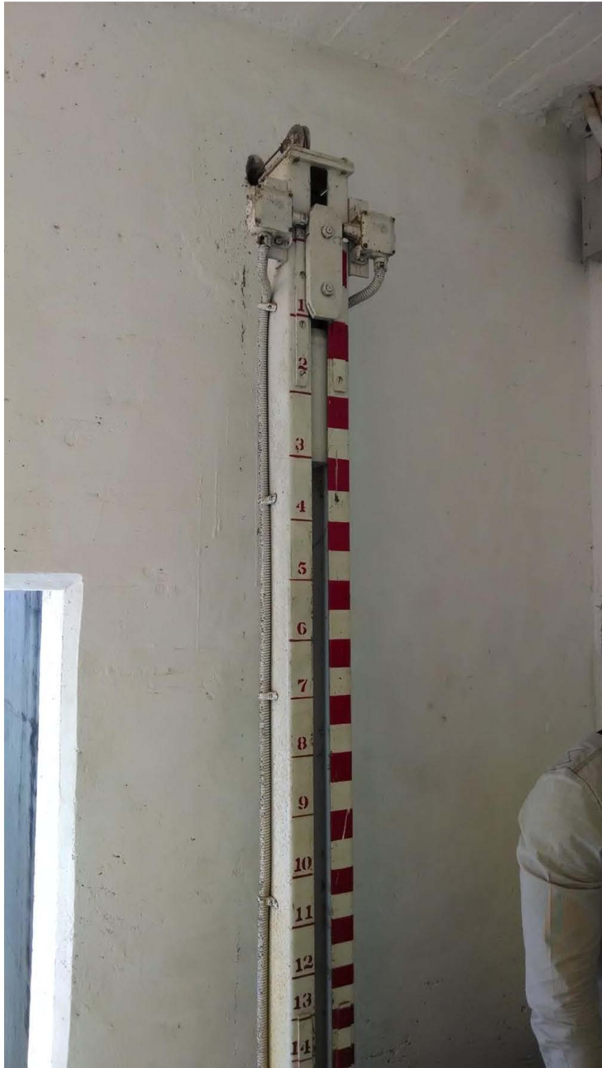
Imagen 6.3.3. Vista del medidor que indica el nivel de apertura de la compuerta
