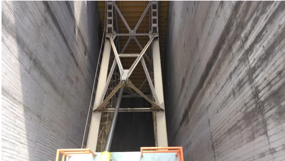
Imagen 6.4.1.1. Vista de una de las compuertas del túnel calafateada.
