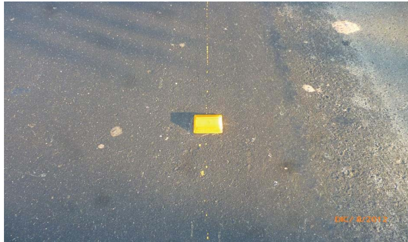
Fotografía 5.33. Imagen vista planta de Vialeta color ámbar colocada sobre las Líneas punteadas en tramo de Puente Playas II.
