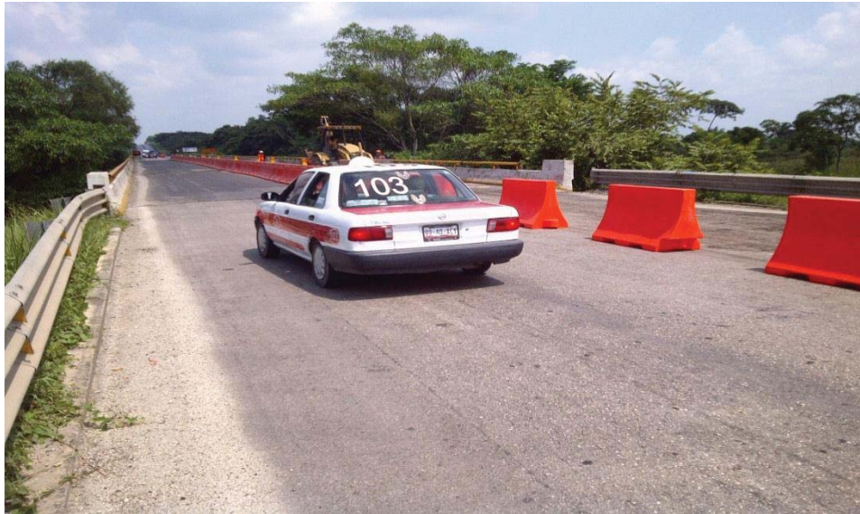
Fotografía 5.4. Barreras alineadas y colocadas para dividir el área donde se efectuaron los trabajos.
