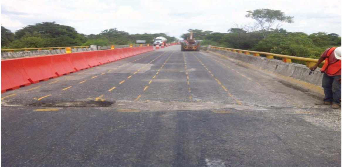
Fotografía 5.1. Vista panorámica, muestra el estado deteriorado de la losa y carpeta.
