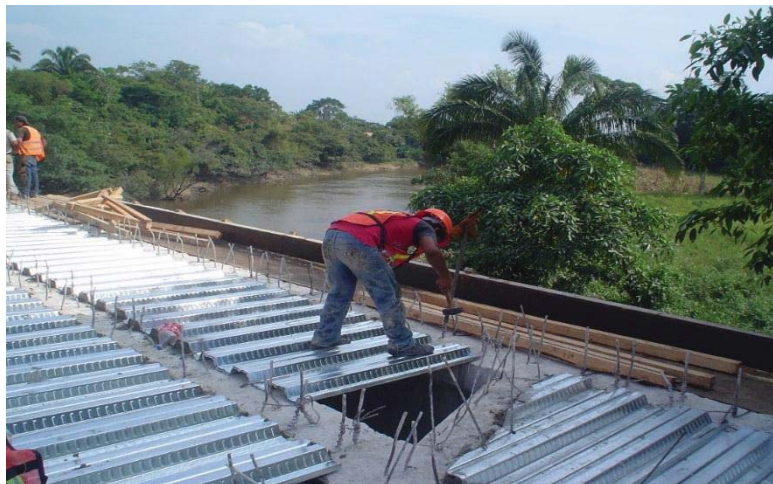
Fotografía 5.13. Colocado de tramos de laminas de losacero y anclaje a las vigas para evitar desplazamientos.
