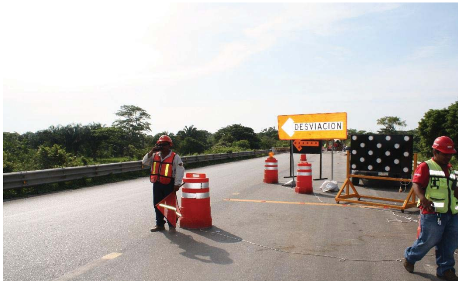
Fotografía 5.3. Dispositivos y señalamiento instalados en obra y elementos de brigada con equipo de seguridad.
