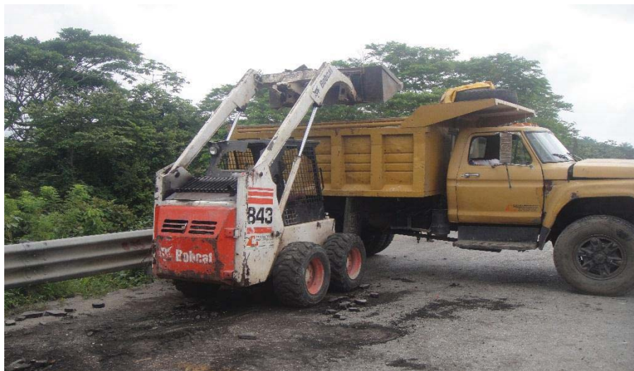
Fotografía 5.6. Colocación de asfalto demolido en camiones para su posterior traslado hacia el área destinada para su depósito.
