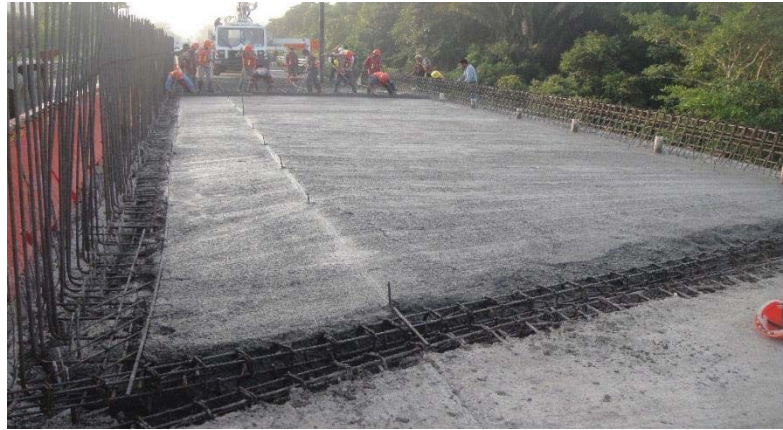
Fotografía 5.18. Colado de Losa 4 de estructura PLAYAS II, con equipo conocido como Bomba Pluma para Concreto.
