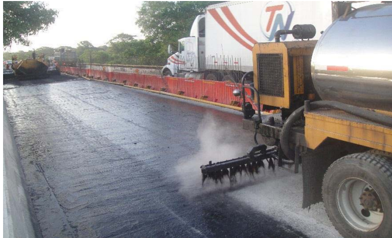
Fotografía 5.25. Tendido de emulsión asfáltica para el riego de Liga con Petrolizadora en Puente Playas II.
