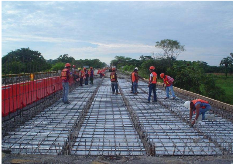
Fotografía 5.16. Imagen de los trabajos de armado de parrilla inferior en losa de puente PLAYAS I.
