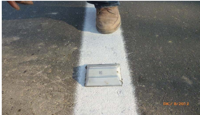
Fotografía 5.31. Alineado y colocación de Vialitas reflejantes color blanco en Línea Continua Playas I.
