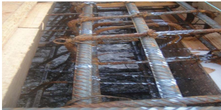
Fotografía 5.19. Imagen que muestra el área donde se ha impregnado de adhecon que evita las juntas frías entre elementos de concreto.
