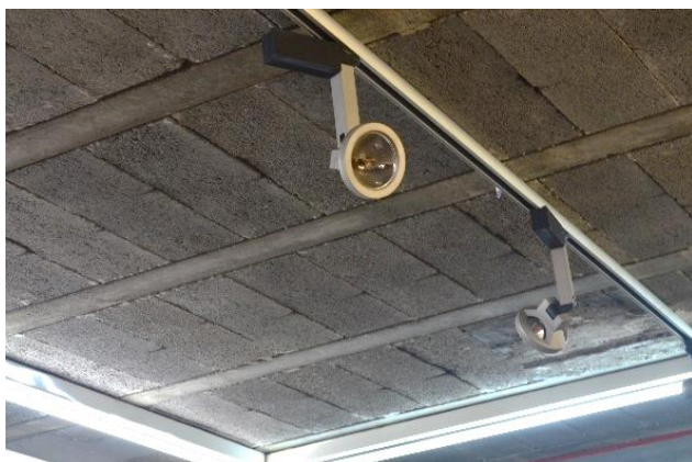
Ilustración 20. Toda la instalación eléctrica de la parte superior permite movilidad de bombillas según la iluminación que se requiera.
