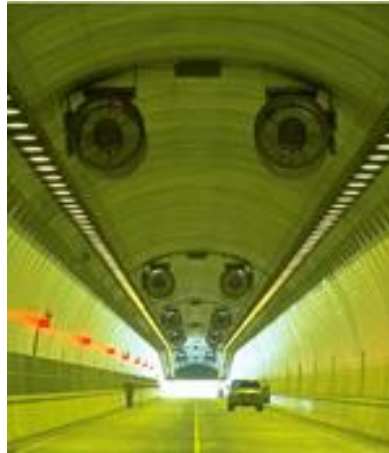
Figura 4.15 Sistema de ventilación con ventiladores de chorro en Túnel Cumberland Gap (www.roadstothefuture.com).
