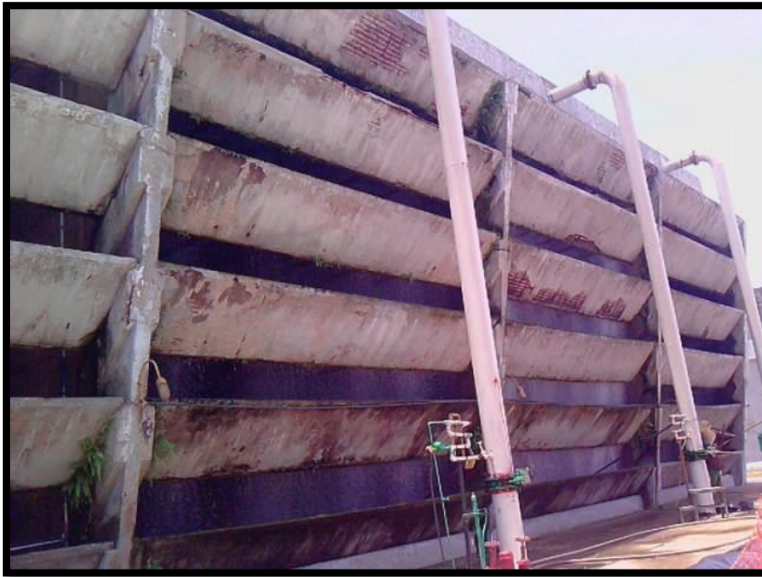
FIGURA 4. Torre de Enfriamiento DE-101.
