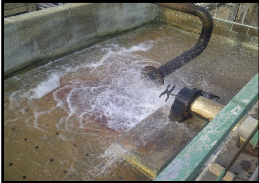
FIGURA 7. Depósito de Agua Caliente.
