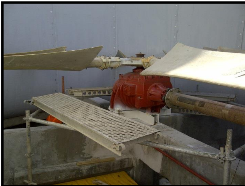
FIGURA 6. Ventilador con Reductor.
