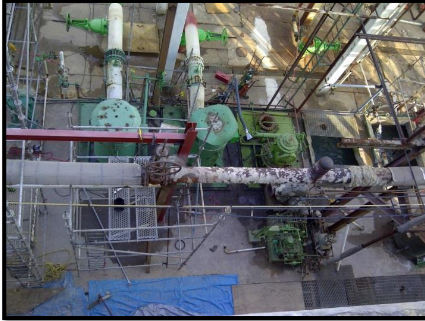
FIGURA 5. Cárcamo de Bombeo.
