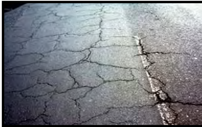
Figura 1.1 Agrietamiento en carpeta asfáltica [48].
