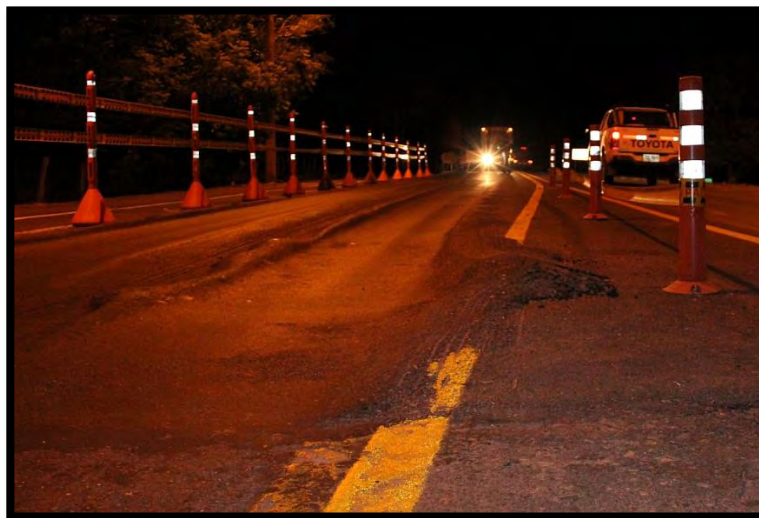
Figura 3.14 Ahuellamiento en carpeta asfáltica [48]
