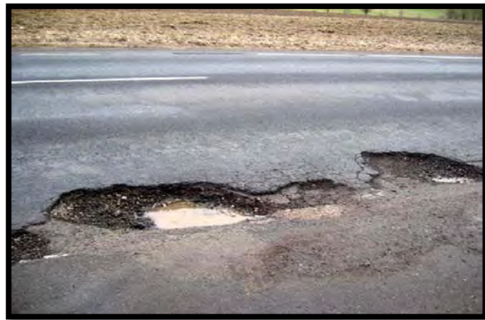
Figura 1.2. Bache en carpeta asfáltica [48].
