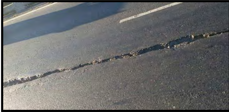
Figura 2.7 Fractura en pavimento asfáltico [48].
