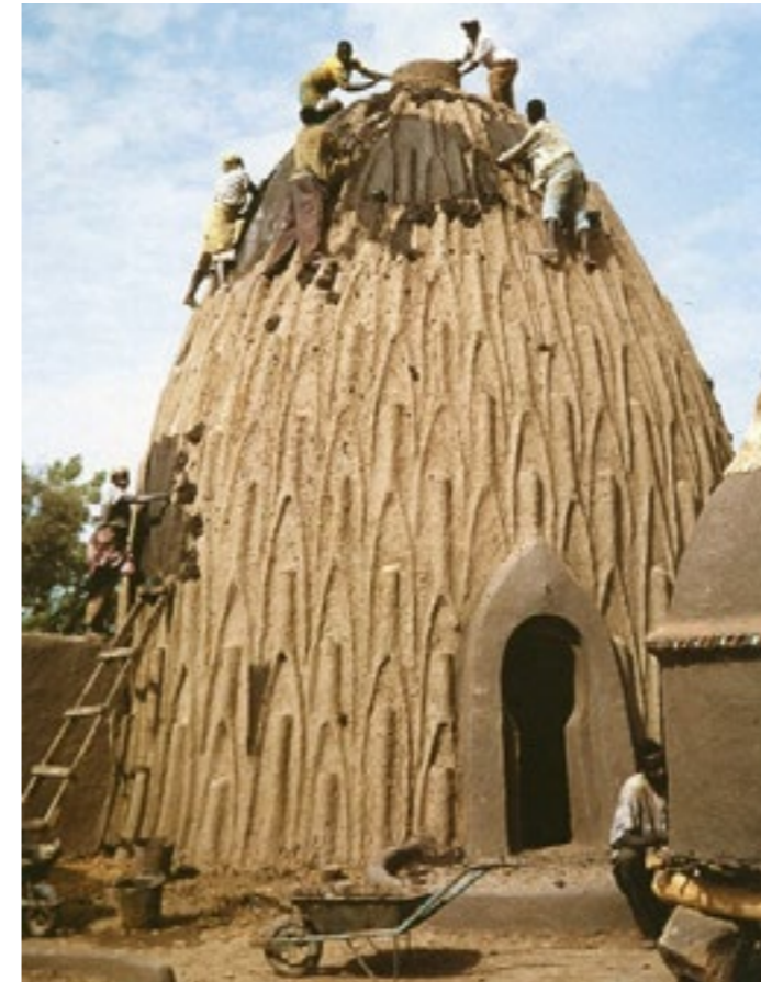
Imagen 64.- Vivienda vernácula. Viviendas en Musgum, Camerún que responden a las condiciones sociales y ambientales del lugar.
