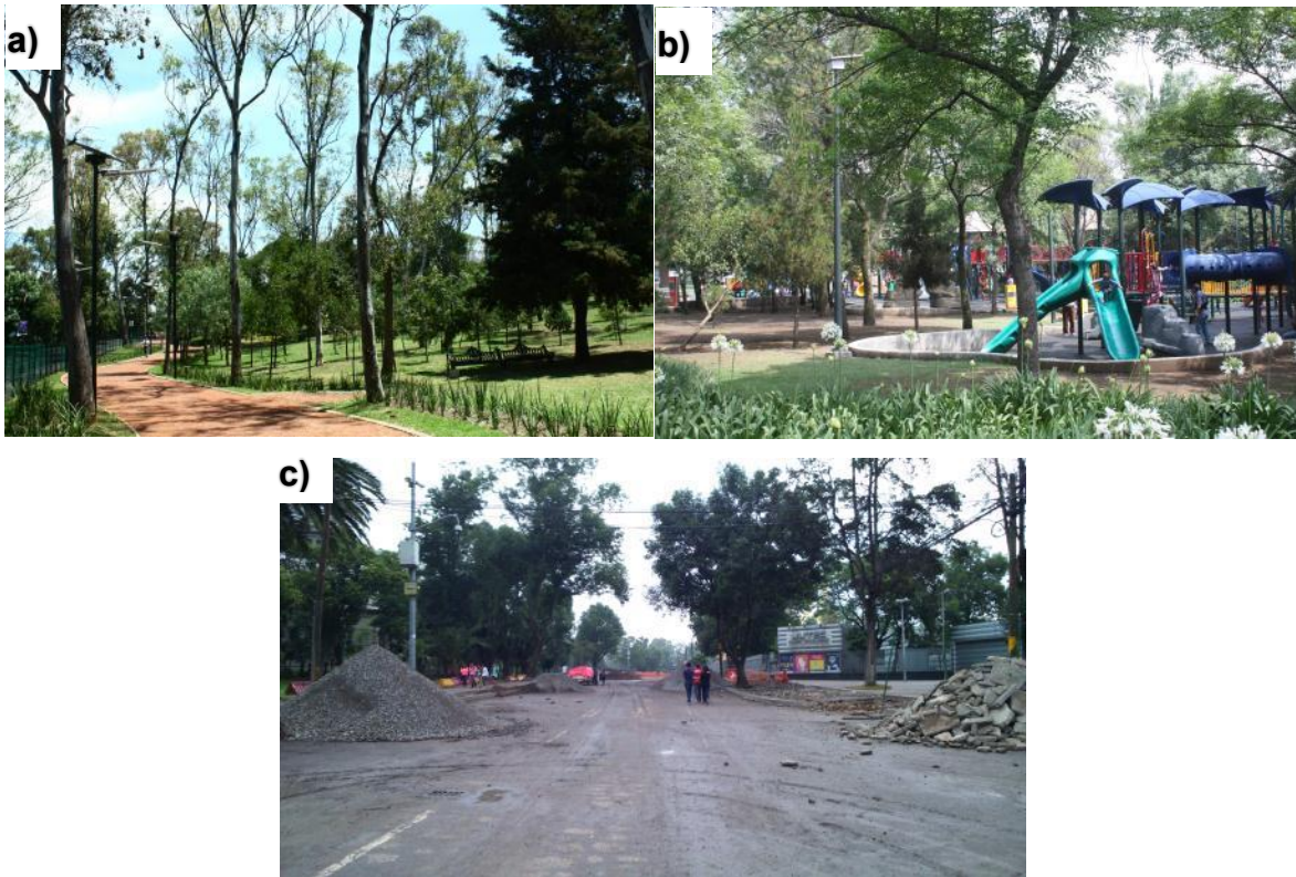
Figura 16| Obras de rehabilitación y remodelación en la Segunda Sección del Bosque de Chapultepec.
