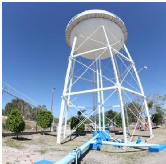
Figura 24. Tanque elevado de agua potable.
