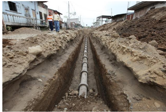
Figura 29. Red de alcantarillado.
