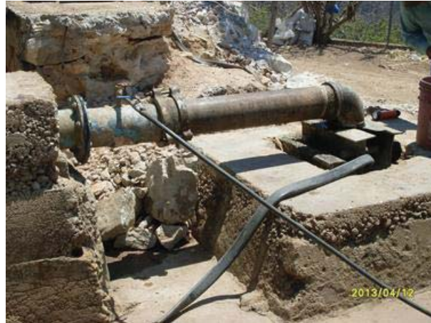
Fig.7.3. Pozo de abastecimiento El Encanto. Localizado en 444134 E, 1852758 N.
