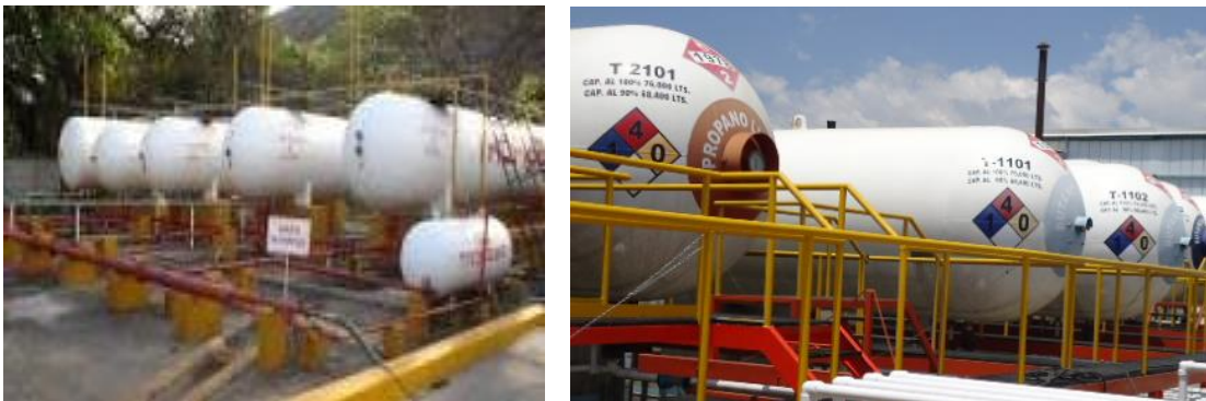
Figura 16. Tanques de almacenamiento de gases hidrocarburo limpio [12]
