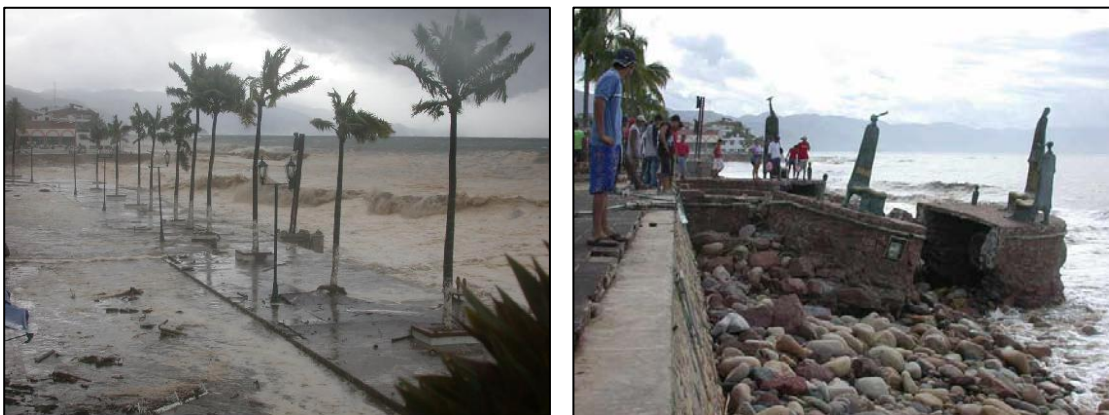
Imagen 12 y 13. Impacto y daños al malecón causados por Huracán Kenna (2002)
