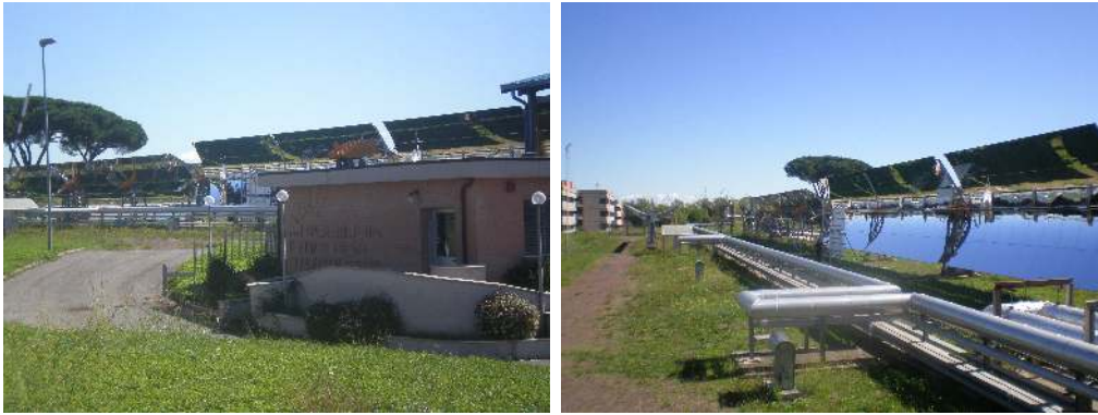
Figure 5.36: Imágenes de la unidad de prueba de colectores solares ENEA. Cassaccia, Italia.
