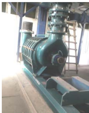
Figura 1.16 Soplador Multietapa (Hoffman). Sala de Sopladores II.
