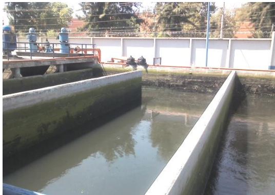
Figura 1.30 Tanque de contacto de cloro.
