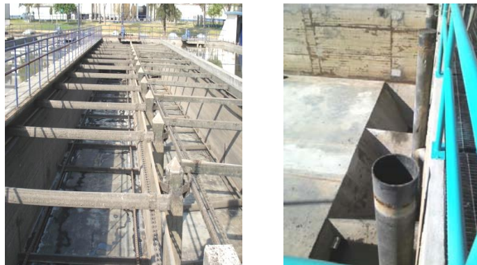
Figura 1.12 Rastras y tolvas del sedimentador primario (Unidad II).
