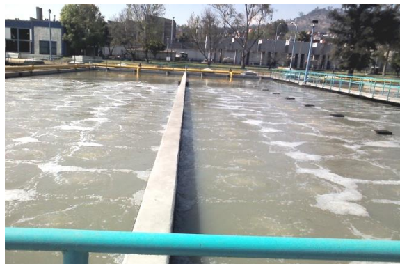
Figura 1.4 Reactor Biológico (Vaso 10 y 11).
