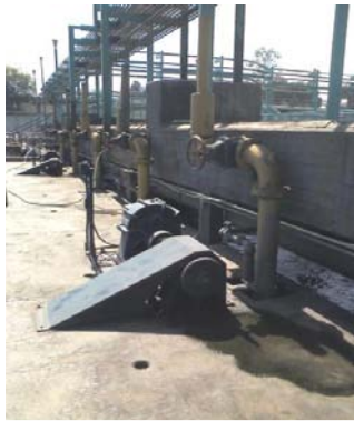
Figura 1.22 Motorreductor (Sedimentador secundario de la
