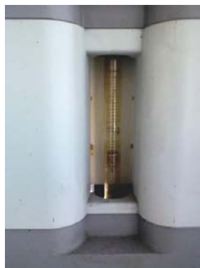
Figura 1.33 Rotámetro (Sala de cloración).
