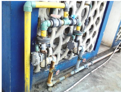
Figura 1.32 Sistema de mezcla del cloro gas (Sala de cloración).
