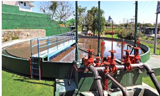
Figura 3.3 Espesador por gravedad con rastras de tipo perimetral. Tomado PTAR del Country Club, Guadalajara, Jalisco. (Consulta 26 de enero de 2015).
