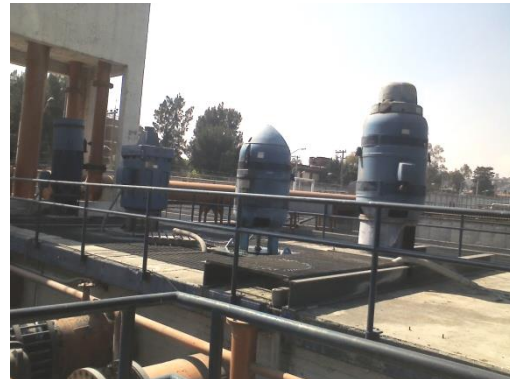
Figura 1.35 Cárcamo de bombeo de agua tratada para la Zona de Zaragoza.
