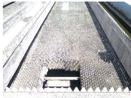
Figura 1.28 Estructura interna del clarificador de la unidad I.
