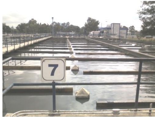
Figura 1.11 Sedimentador primario (Unidad II).
