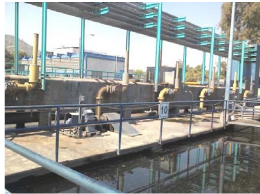
Figura 1.23 Canaleta de lodos y sistema air-lift (Unidad III).
