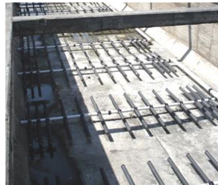
Figura 1.20 Difusores de aire del reactor biológico (Unidad I).
