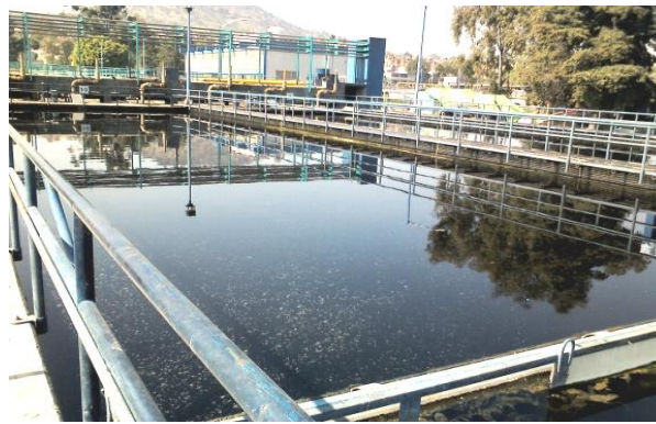
Figura 1.21 Sedimentador secundario (Unidad III).
