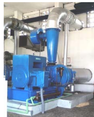
Figura 1.17 Soplador tipo Turbina (Turblex). Sala de Sopladores I.
