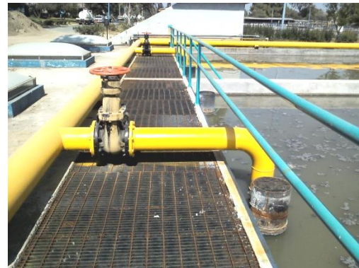
Figura 1.3 Válvulas de recirculación de lodos (Reactor Biológico).
