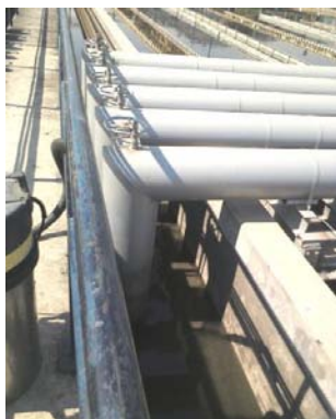
Figura 1.24 Canaleta de descarga y recirculación de lodos (Unidad IV).
