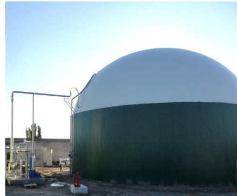
Figura 3.7 Tanque de almacenamiento de biogás con tapa flexible. Tomado de PTAR Padua, Italia. (Consulta 23 de enero de 2015).
