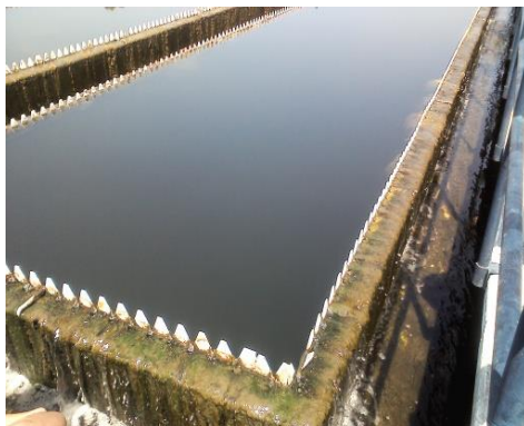
Figura 1.27 Clarificador de la unidad
