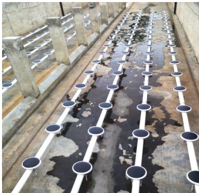
Figura 1.2 Difusores de aire tipo membrana (Reactor Biológico).
