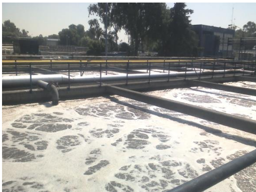
Figura 1.19 Reactor Biológico (Unidad III).
