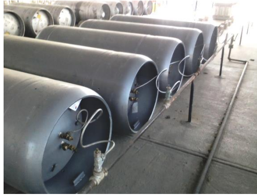
Figura 1.31 Tanques de almacenamiento de cloro gas.
