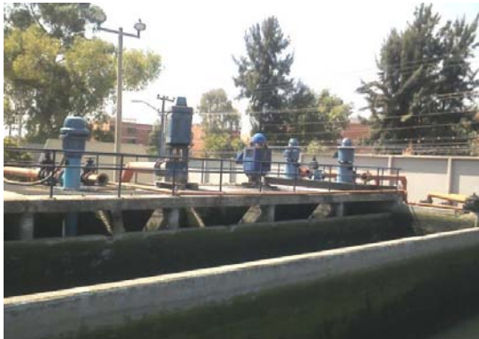
Figura 1.34 Cárcamo de bombeo de agua tratada para Xochimilco y Zona industrial.
