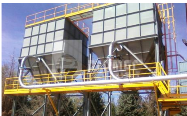
Figura 3.10 Tolvas para almacenamiento de biosólidos. Tomado http://www.pramar.net/es/Web/solicitud_codigo (Consulta 26 de enero de 2015).
