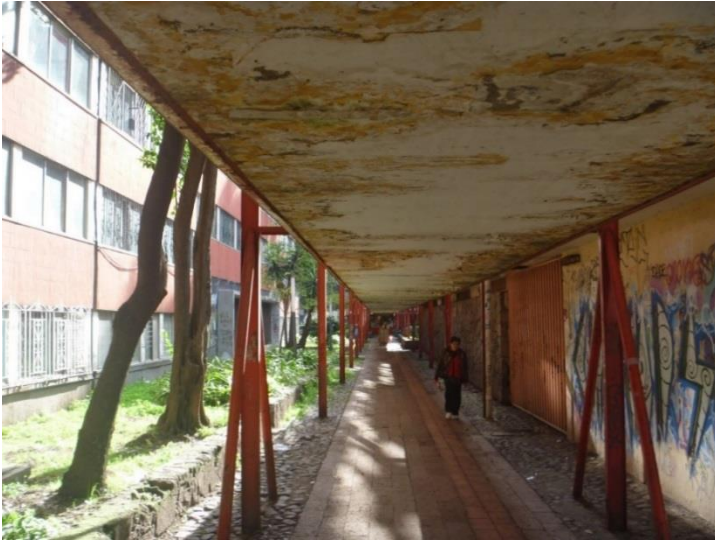
Imagen 10: Deterioro en áreas comunes
