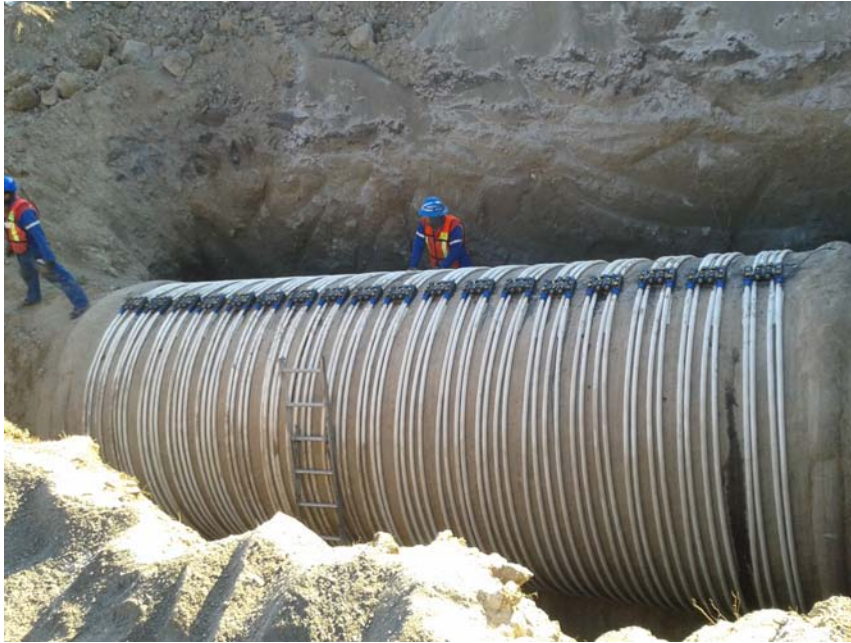
Figura 3.26: PCCP con reforzamiento externo Freyssinet. Fuente: autoría propia.
