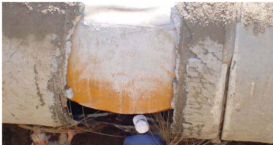
Figura 2.23: Falla local en la tubería enterrada (León, 2004).
