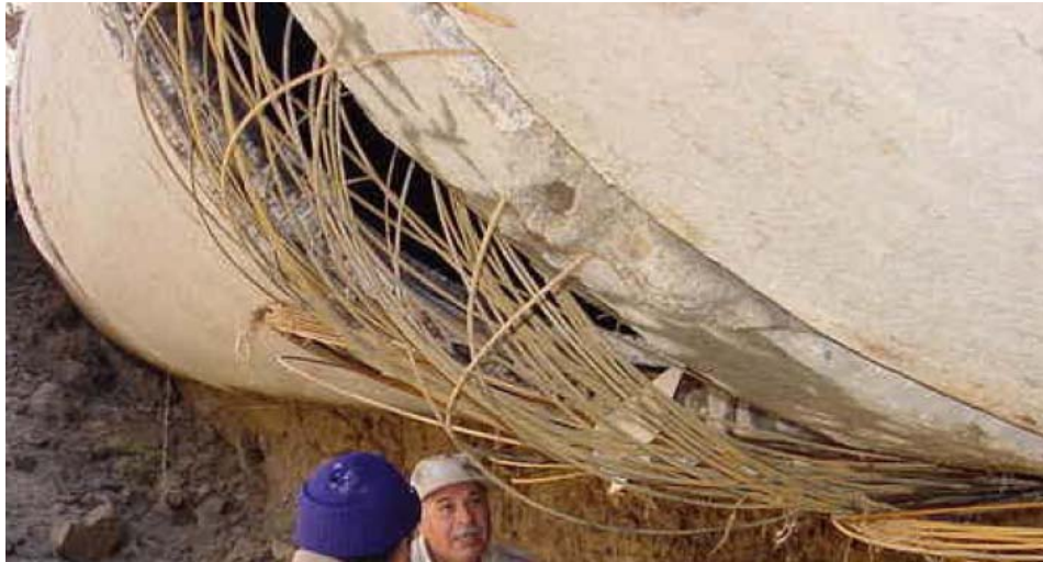
Figura 2.22: Espiras de presfuerzo rotas por la acción de la corrosión (León, 2004).
