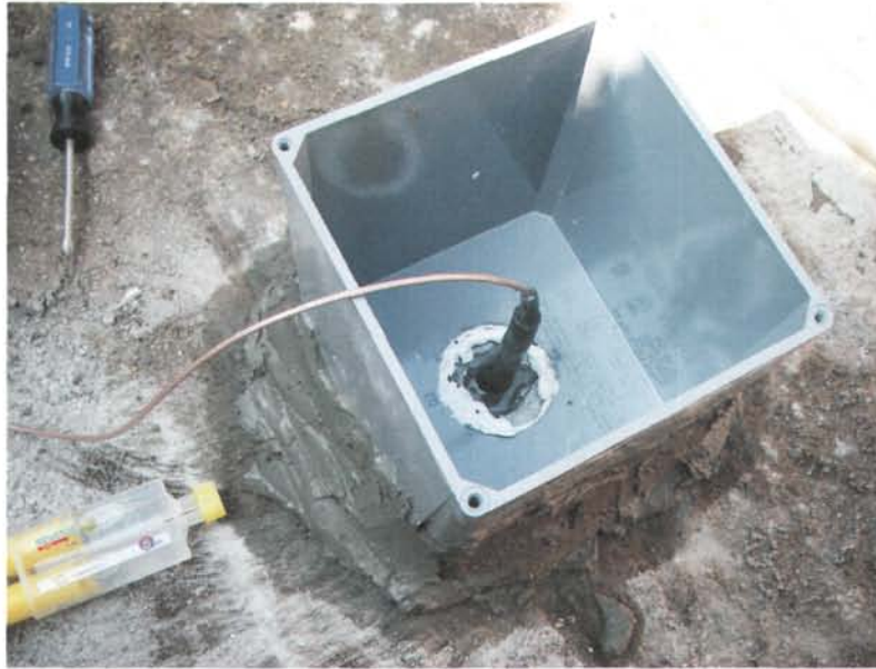
Figura 2.26: Instalación de un acelerómetro en el lomo del tubo (Callejas, 2011).
