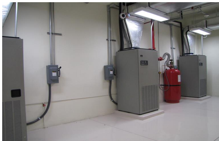
Imagen 14: Se observan los tres equipos de precisión, el tanque de gas FM200, y una de las cámaras de seguridad.
