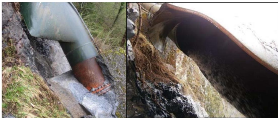
Figura 2.1. Ruptura de una línea de conducción causado por un cierre instantáneo en Francia (Kueny, Combes, Lourenço, Clary, & Ballester, 2014)
