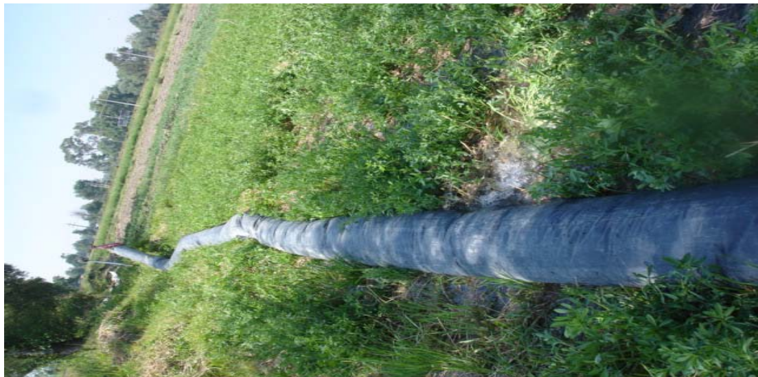
Fuente: Trabajo de campo (2010). Sistema de riego de las parcelas ejidal a través del bombeo de agua de pozo impulsado por motor de eléctrico.
