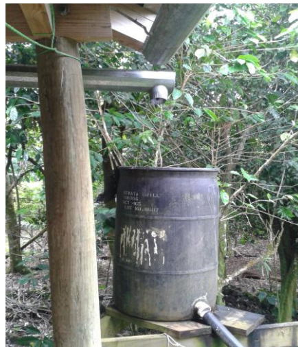
Figura 3.11.- Canaletas y contenedores en desuso.
