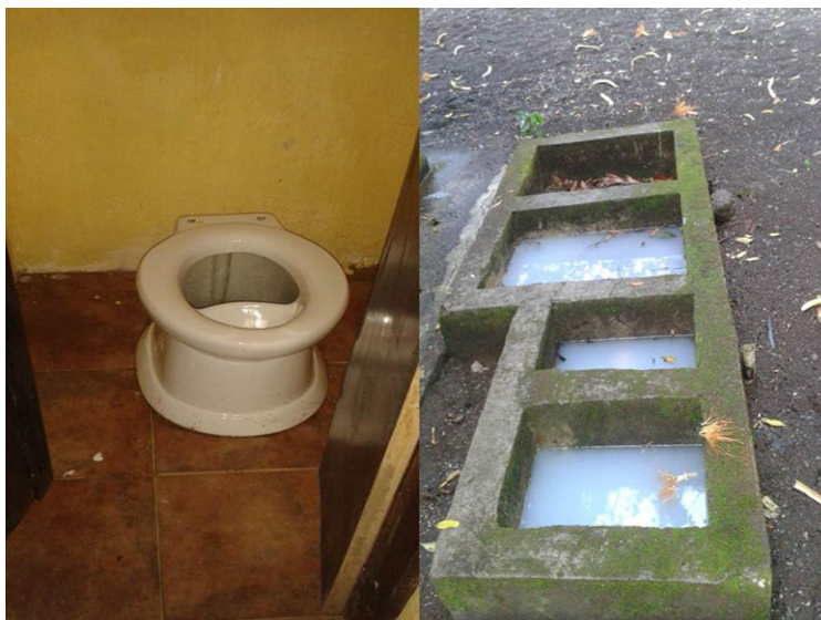
Figura 3.14.- Baño seco y contenedor de aguas jabonosas.
