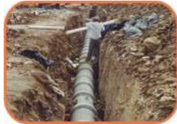
Colector Drenaje, Calle Fresno Jazmín, Col. Buenos Aires
