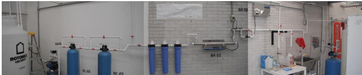
Figura 40. Muestra la Planta Purificadora de Campus II en la fase de Tratamiento Completo.
