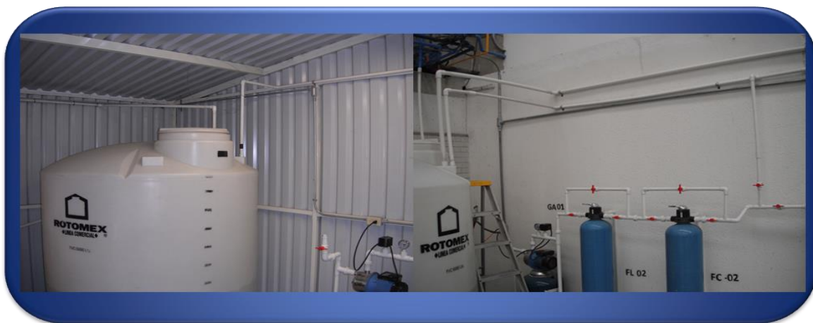
Figura 45. Muestra los tanques de pretratamiento TQ-01 de las plantas purificadoras.
