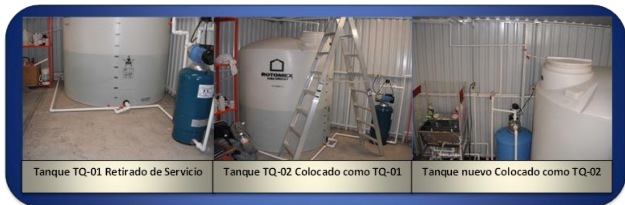
Figura 52. Muestra los Tanques TQ-01 y TQ-02 de la planta purificadora de Campus I.
