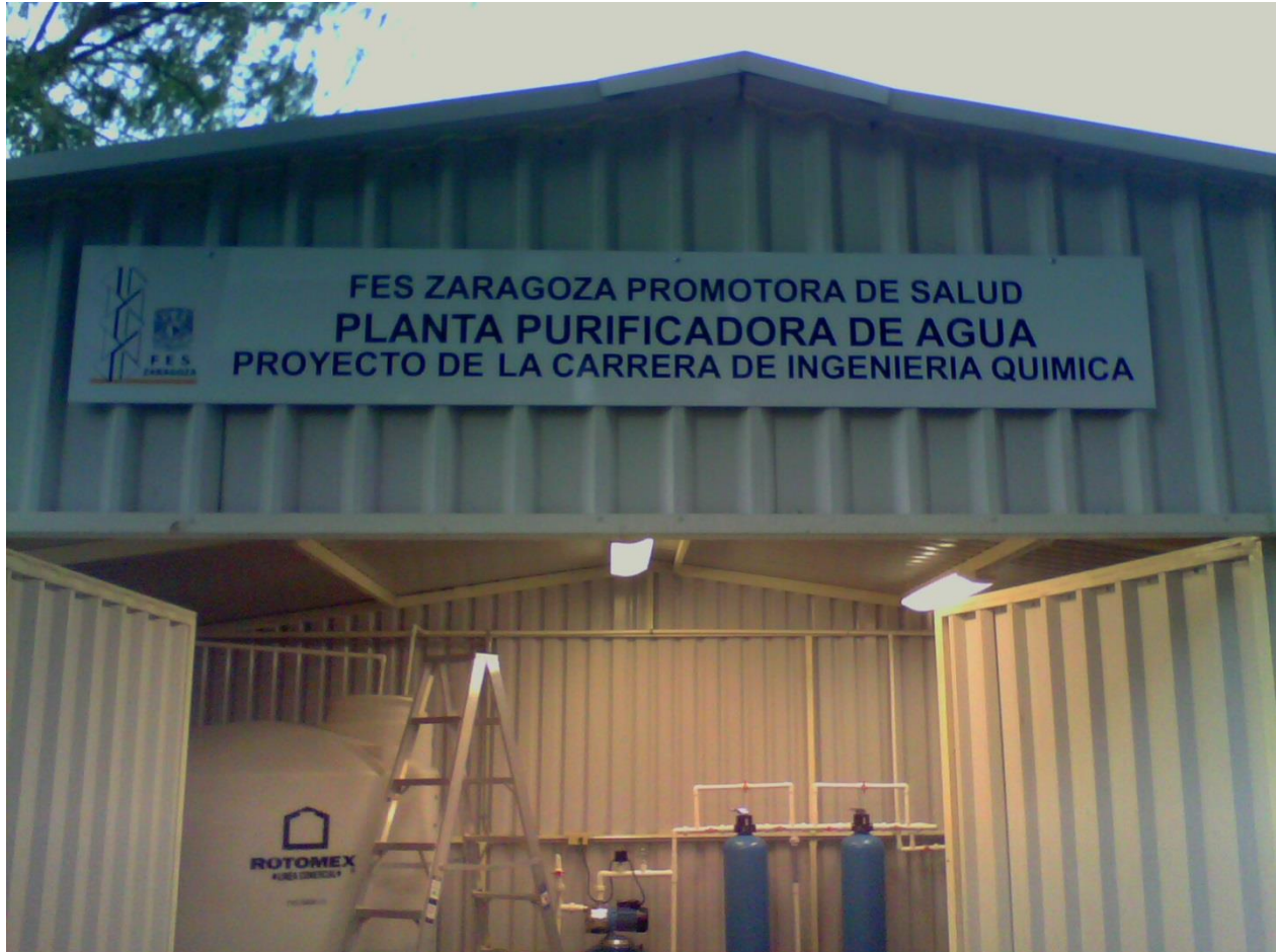
Figura 22. Muestra la planta purificadora de agua de Campus I.
