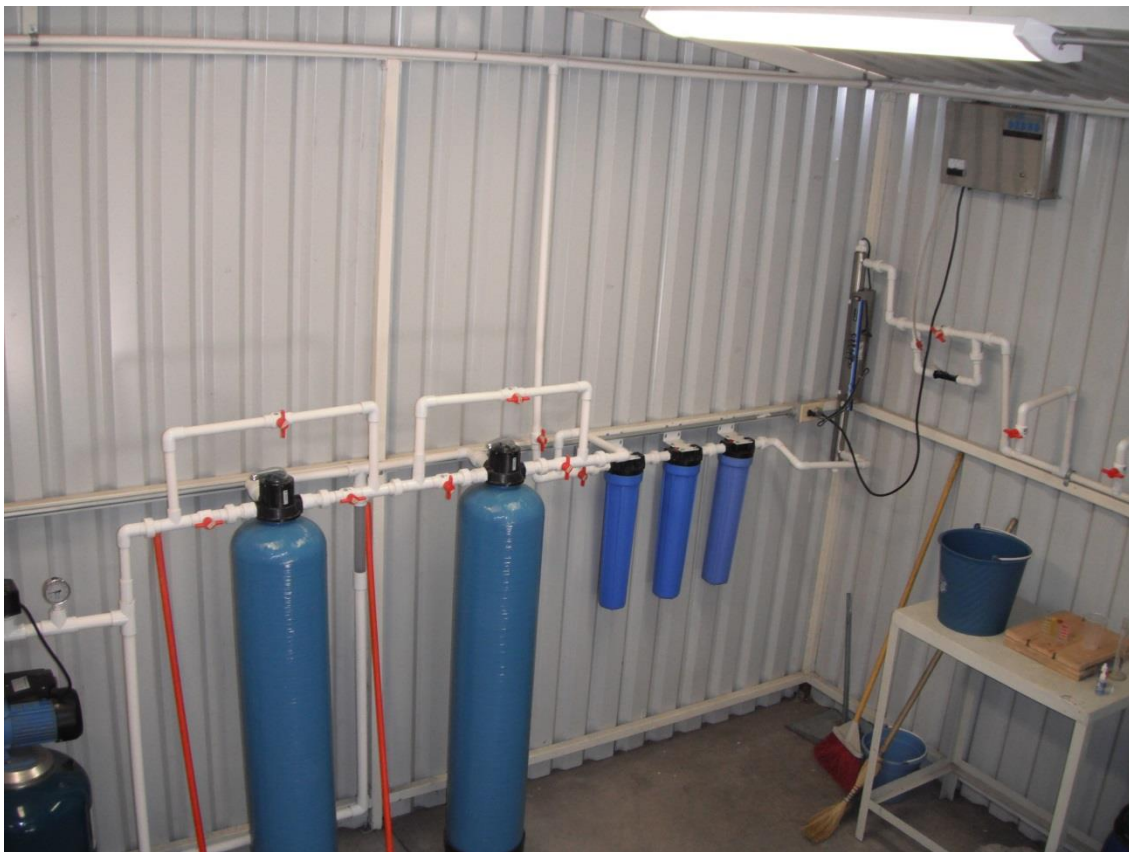
Figura 37. Muestra la Planta Purificadora de Campus I en la fase de Pretratamiento.
