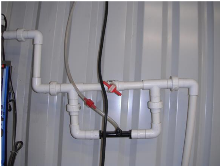
Figura 39. Tubo Venturi para contacto con el ozono en la Planta Purificadora de Campus I.
