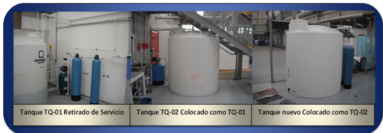
Figura 53. Muestra los Tanques TQ-01 y TQ-02 de la planta purificadora de Campus II.
