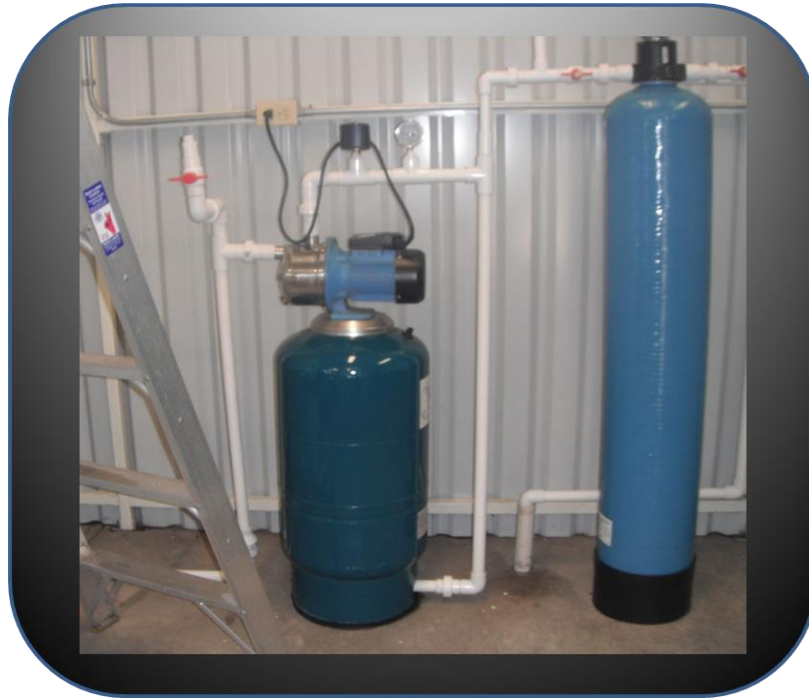
Figura 57. Muestra el nuevo filtro multicapa de lecho profundo FL-01 en Campus I.
