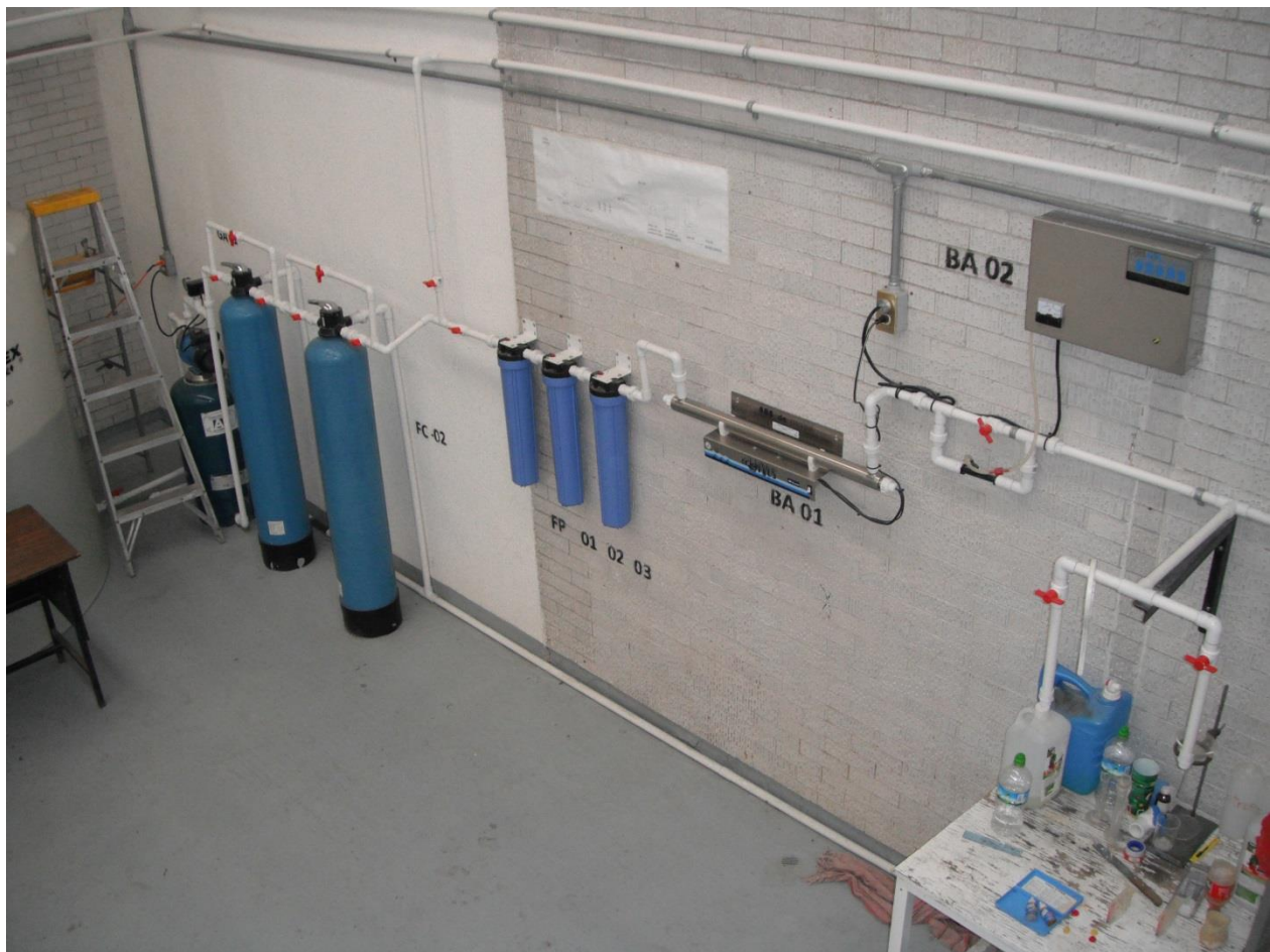
Figura 41. Muestra la Planta Purificadora de Campus II en la fase de Tratamiento Completo.
