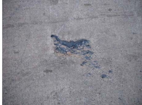
Figura. 2.1 Fotografía de un piso con un deterioro a simple vista; la parte faltante dejó un hueco que fácilmente se desmorona.
