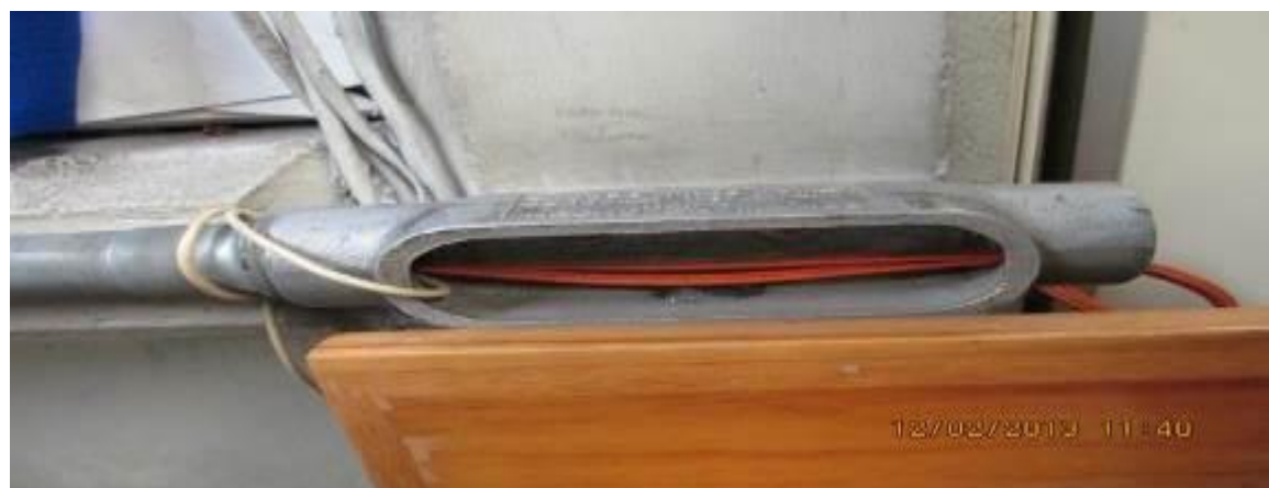
Ilustración 14. Canalización incompleta y sin tapa
