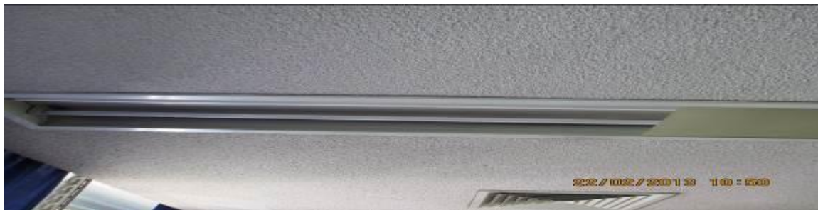
Ilustración 43. Luminaria sin difusor
