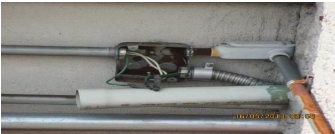
Ilustración 78. Cajas oxidadas, sin tapas y empalmes expuestos
