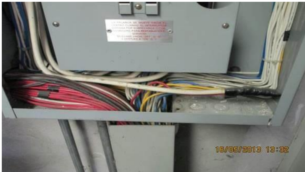
Ilustración 67. Salida de cables mal cerrada
