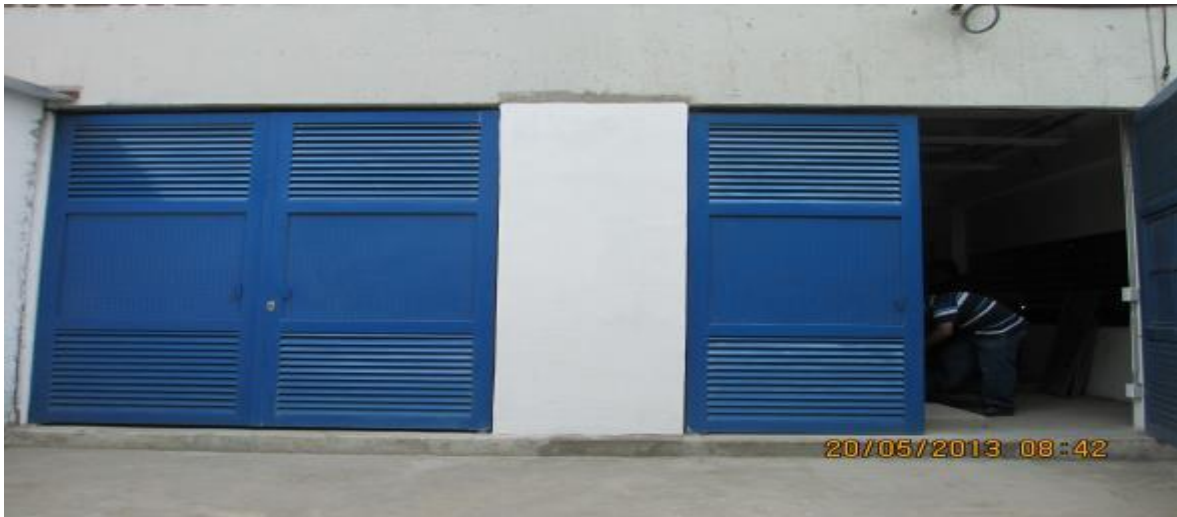
Ilustración 83. Entrada a la subestación eléctrica
