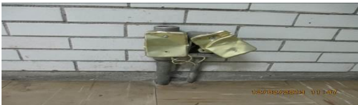
Ilustración 17. Tapas dañadas y cable expuesto
