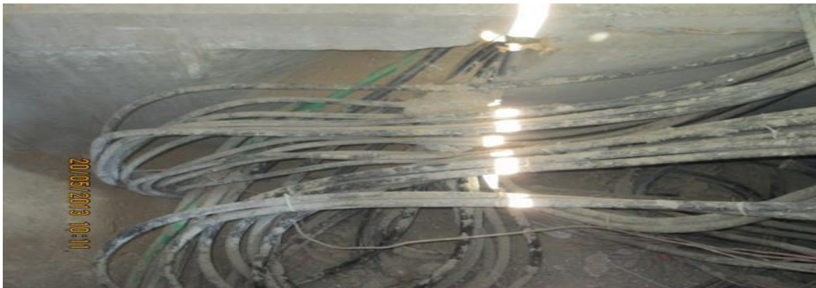
Ilustración 86. Trincheras sin tapa y en mal estado
