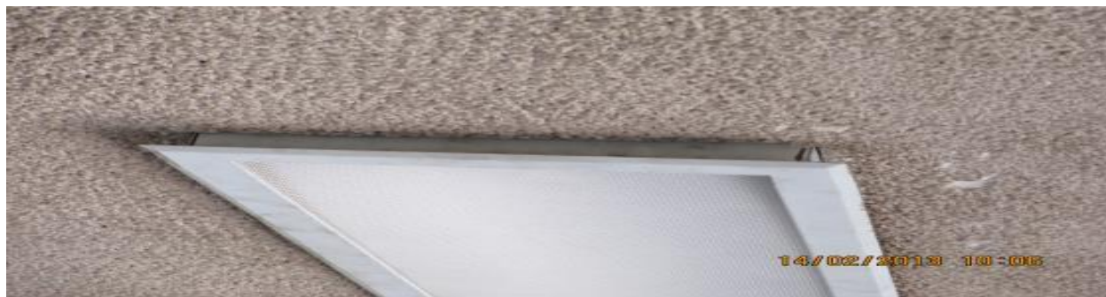
Ilustración 59. Luminarias mal empotrada
