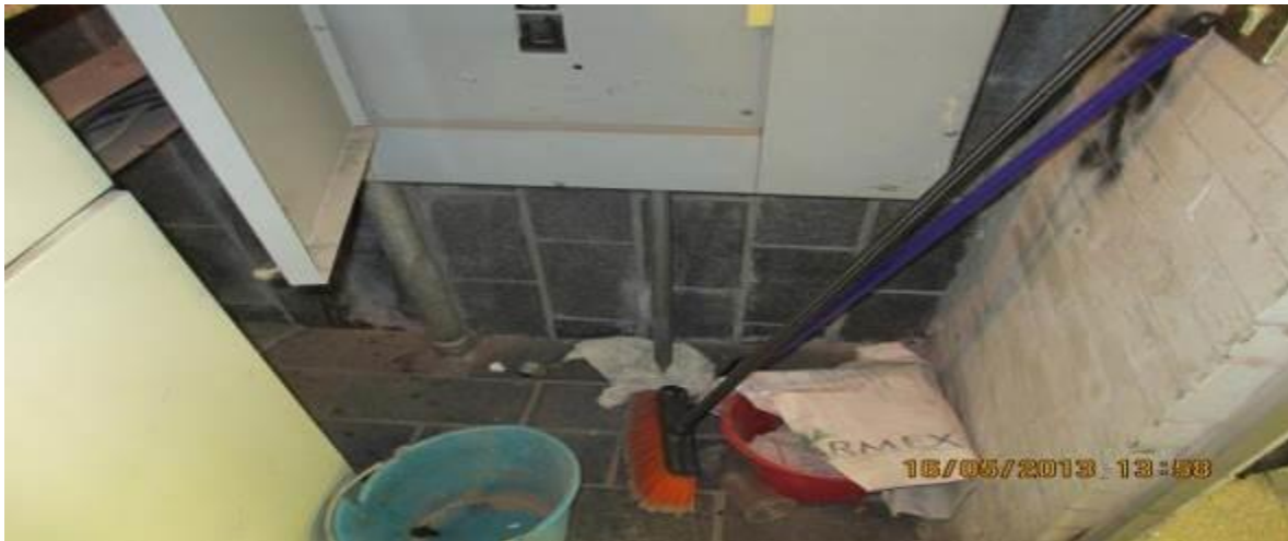
Ilustración 69. Cuartos eléctricos usados como bodegas
