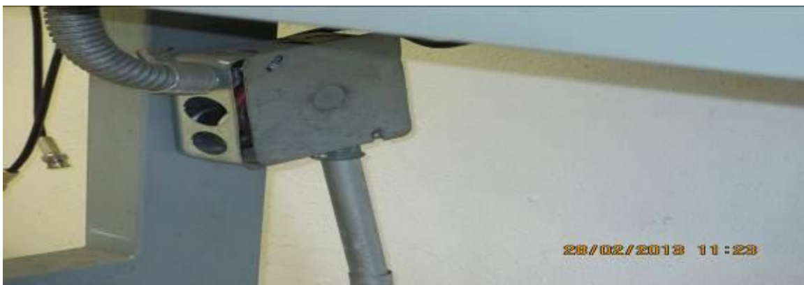
Ilustración 52. Tapa mal colocada y espacios sin cerrar
