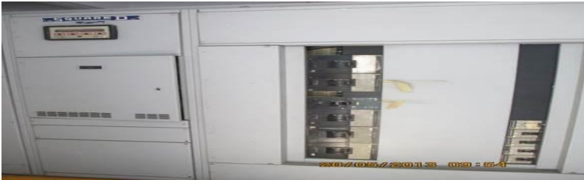
Ilustración 85. Interruptores sin identificar
