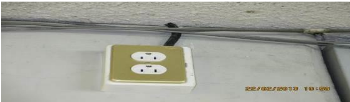
Ilustración 34. Cables a traves de techo
