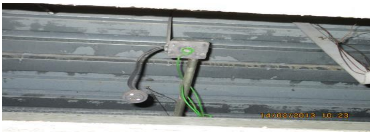
Ilustración 61. Cables sin protección
