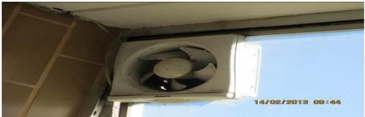
Ilustración 64. Ventilador con alimentador que va a través del techo
