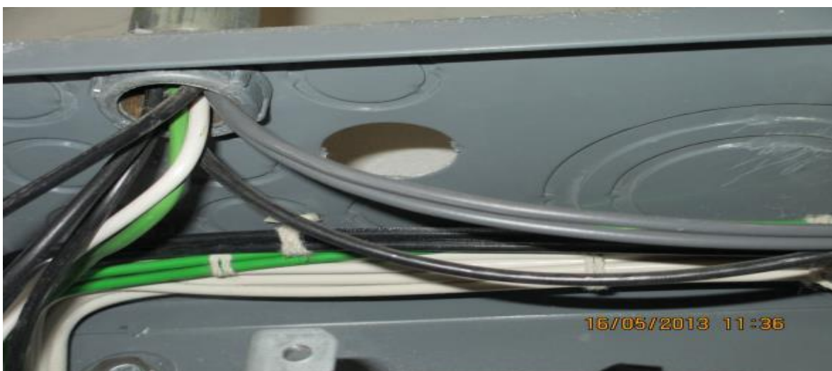
Ilustración 68. Huecos sin utilizar y sin cerrar
