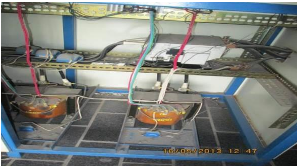
Ilustración 70. Falta de tapa del regulador
