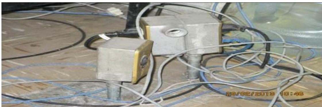
Ilustración 38. Cajas mal ubicadas
