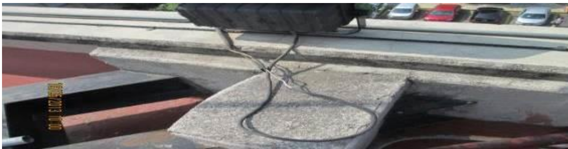
Ilustración 81. Cables sin protección y falta de conexión a tierra
