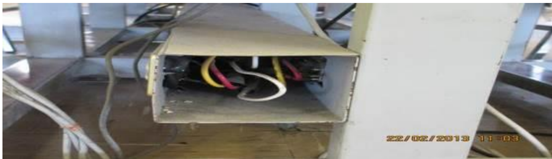
Ilustración 30. Canalización sin tapa
