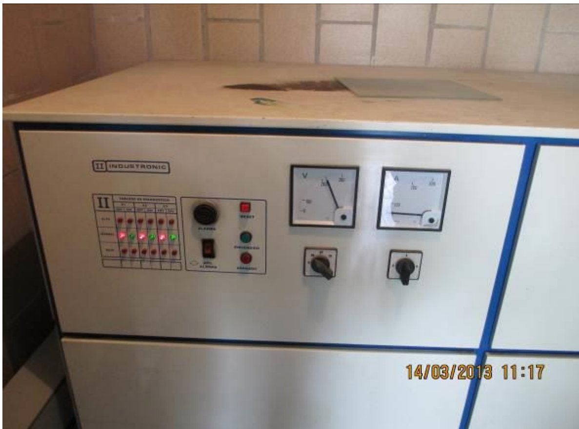
Ilustración 90. Regulador de cuarto eléctrico
