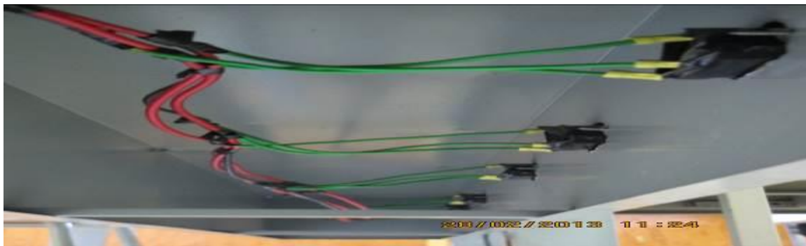
Ilustración 51. Falta de canalización y protección para cables
