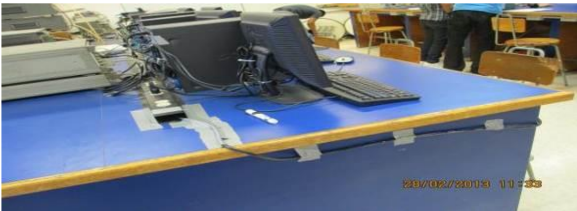
Ilustración 49. Alimentación provisional conectada a un solo contacto
