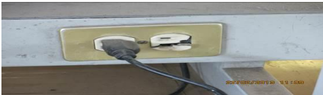
Ilustración 33. Contacto en mal estado
