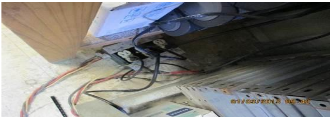
Ilustración 54. Uso de contactos provisionales y sin protección
