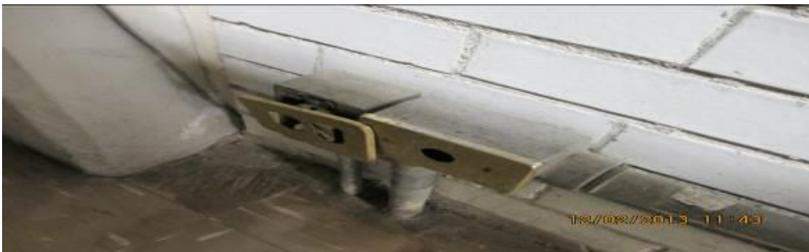
Ilustración 20. Tapas en mal colocadas
