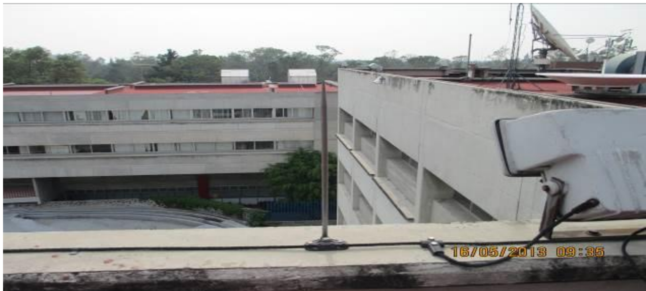
Ilustración 10. Luminaria y punta de pararrayos, azotea
