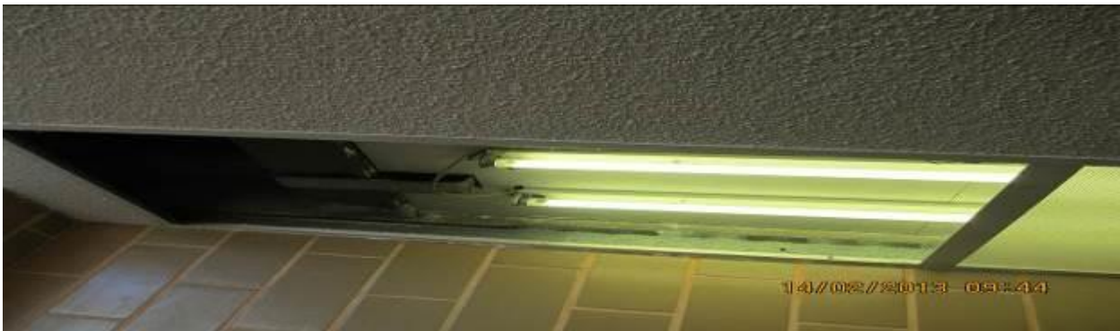
Ilustración 63. Luminaria sin difusor
