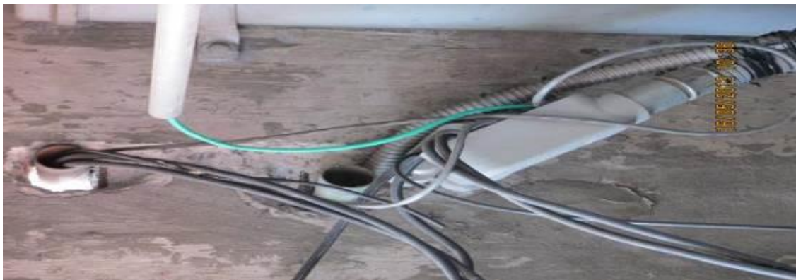
Ilustración 79. Cables sin protección
