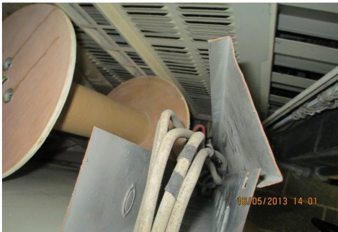
Ilustración 72. Canalización que no protege alimentadores
