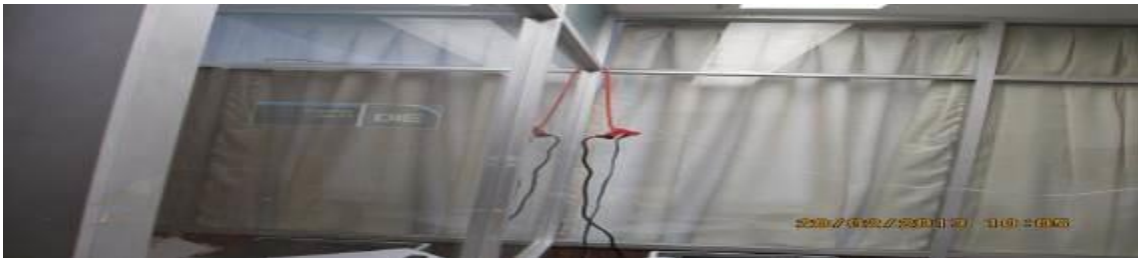
Ilustración 46. Uso de extensiones en sustitución de la instalación fija
