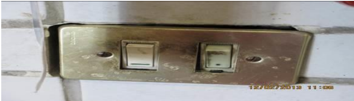
Ilustración 18. Apagador mal empotrado
