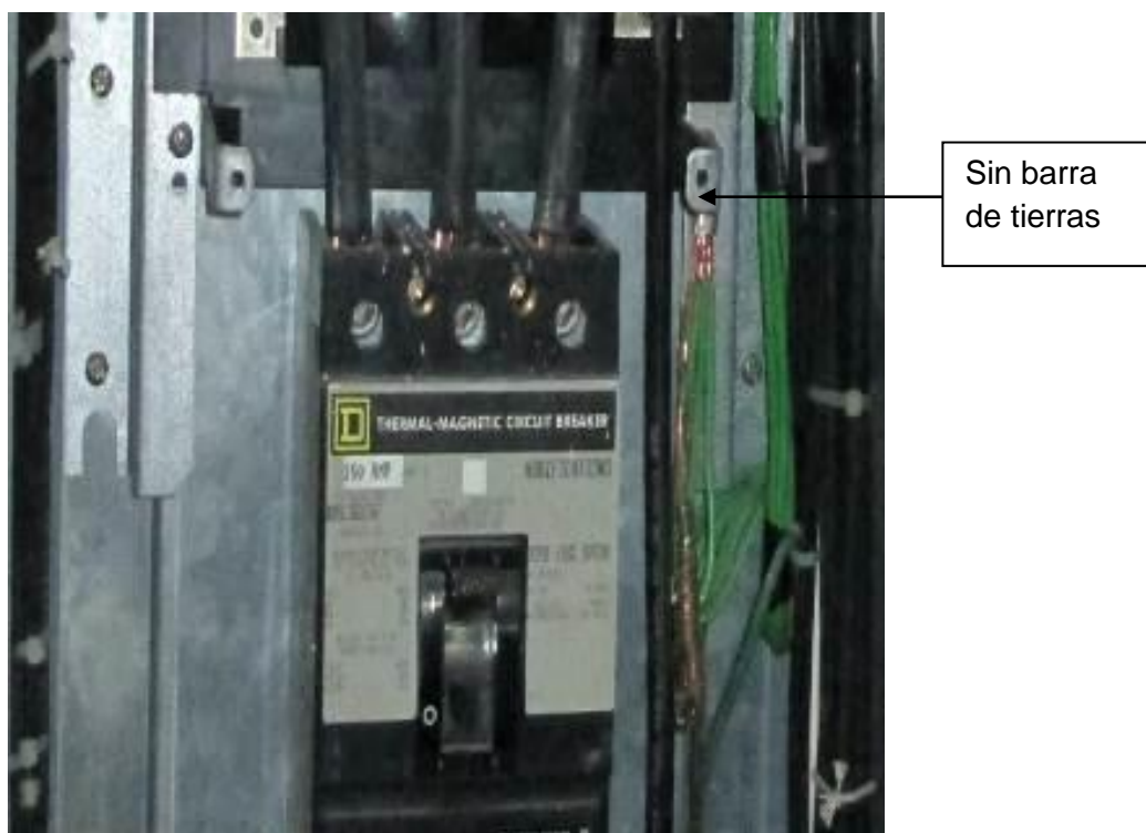
Ilustración 88. Tablero sin barra de tierras
