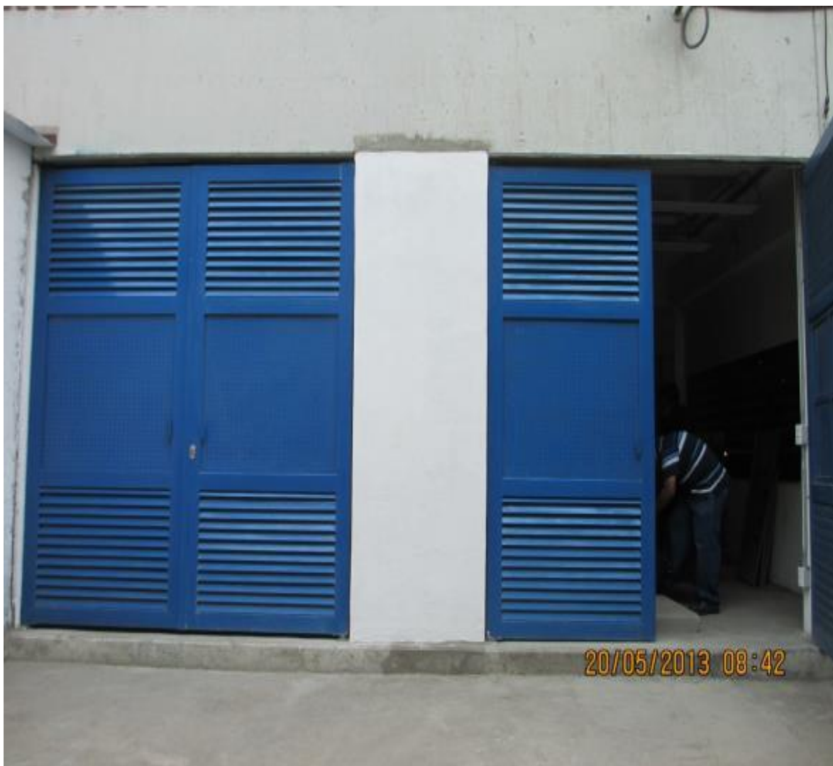
Ilustración 89. Falta de letreros de advertencia (subestación)
