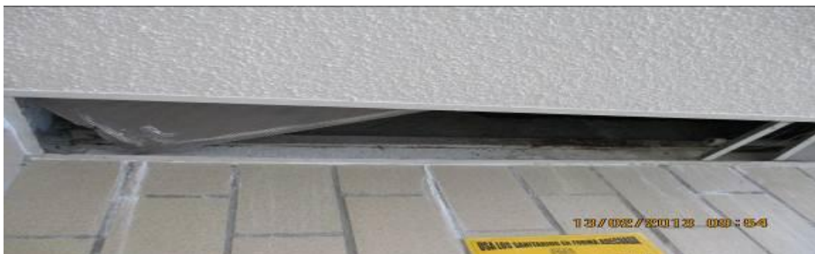
Ilustración 16. Difusor roto y mal colocado
