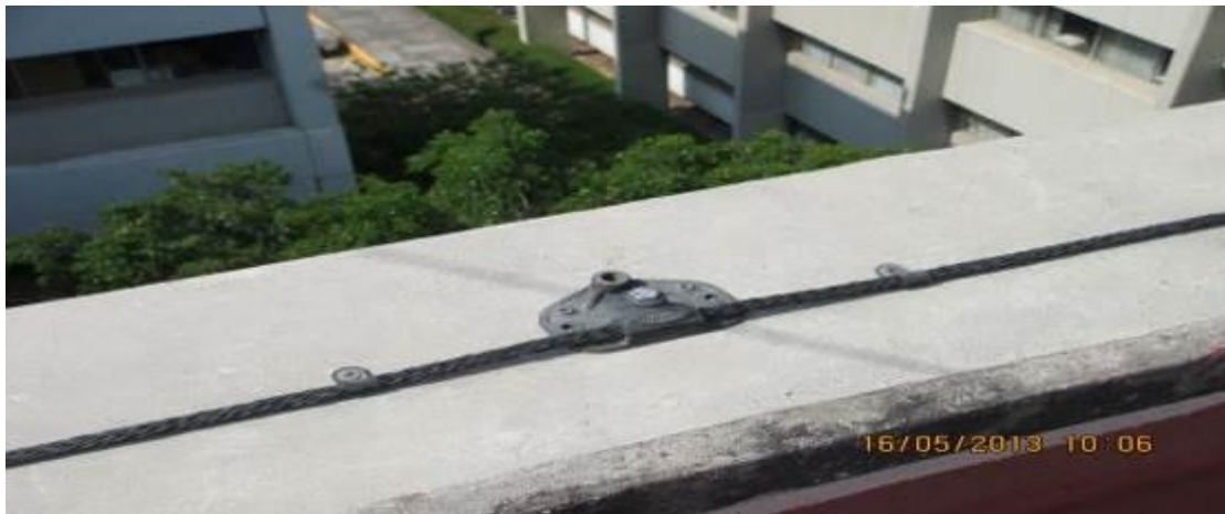
Ilustración 74. Falta de punta de pararrayos
