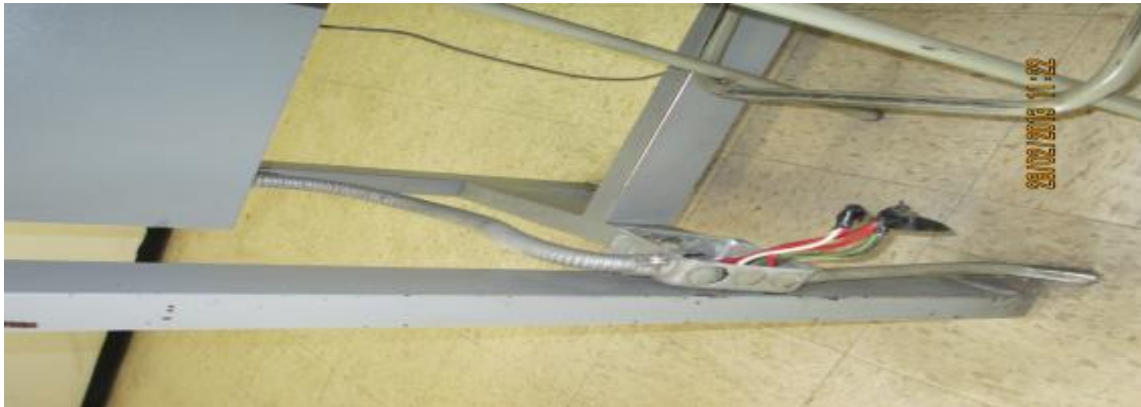
Ilustración 50. Caja sin tapa y empalmes expuestos
