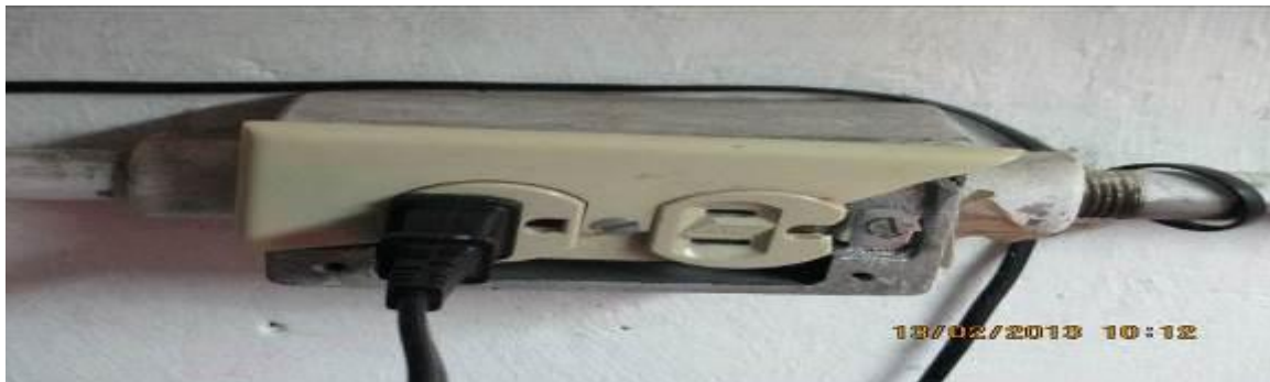
Ilustración 15. Contactos en mal estado
