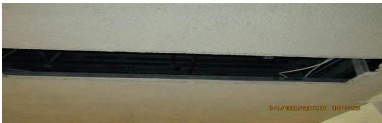
Ilustración 60. Espacio de luminaria sin ocupar
