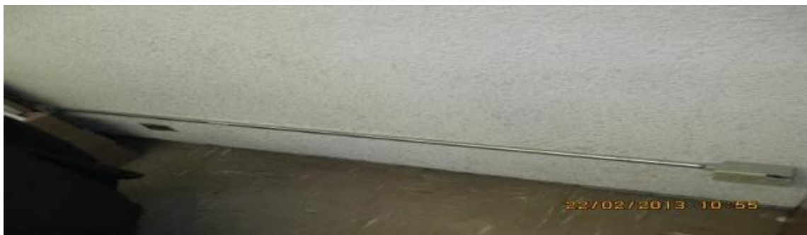
Ilustración 45. Tapa rota y sin soporteria adecuada
