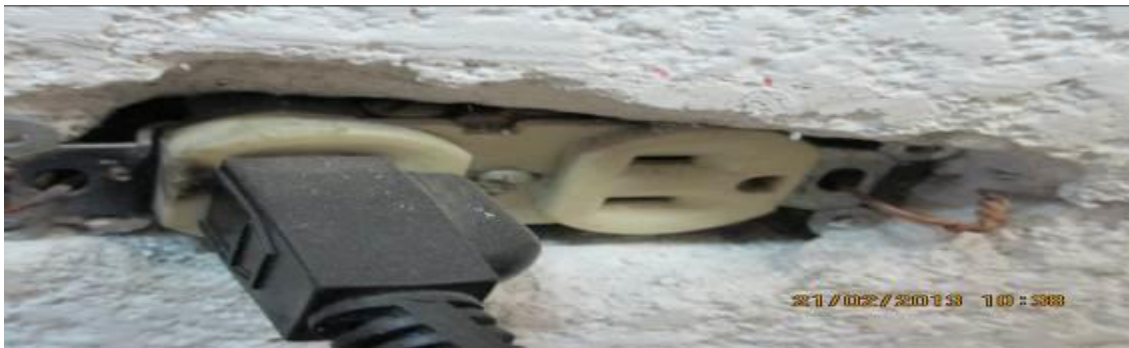
Ilustración 40. Contacto mal colocado, sin tapa y espacio sin resanar
