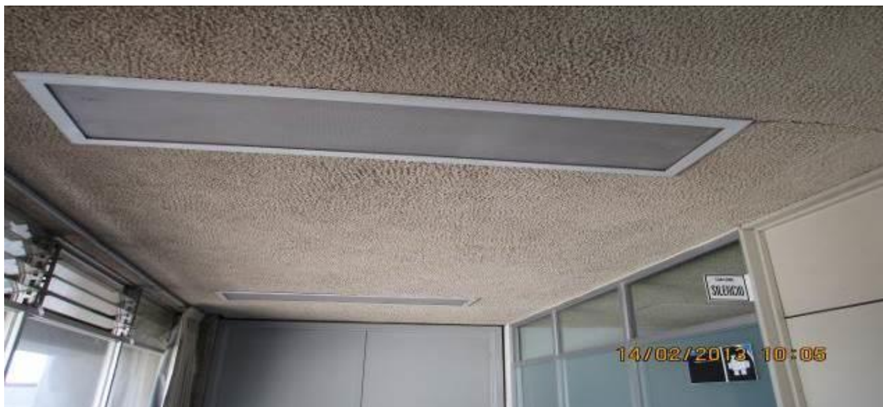
Ilustración 9. Luminaria del tercer piso
