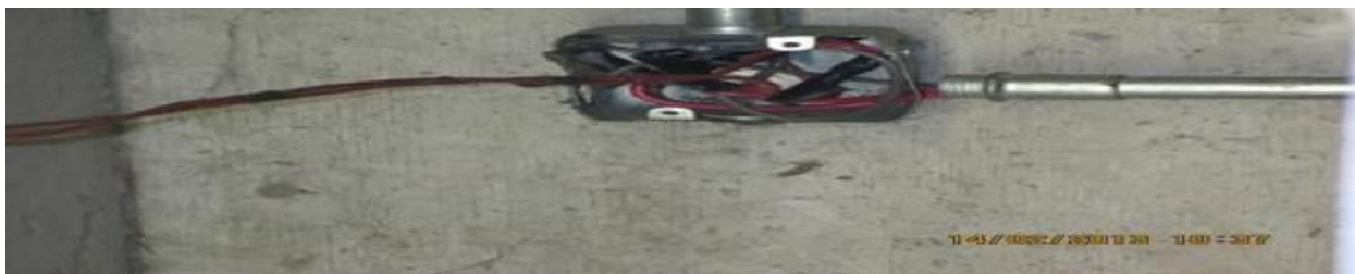
Ilustración 47. Caja de paso sin tapa
