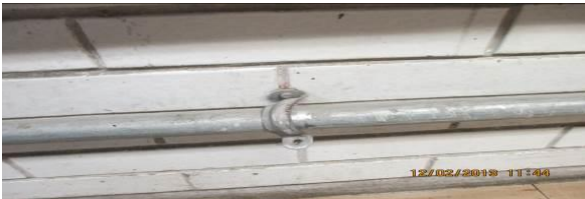
Ilustración 19. Soporte de tubería dañado
