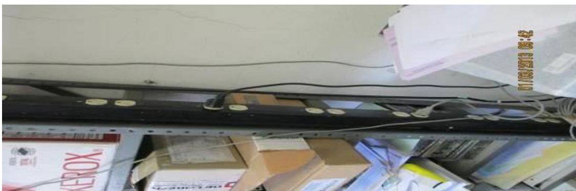
Ilustración 55. Canaletas provisionales sobre estantes
