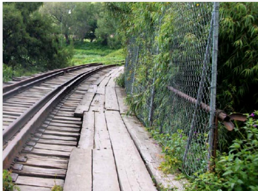
Figura 2.4 Arreglo de vías de ferrocarril y andador peatonal improvisado con malla de protección
