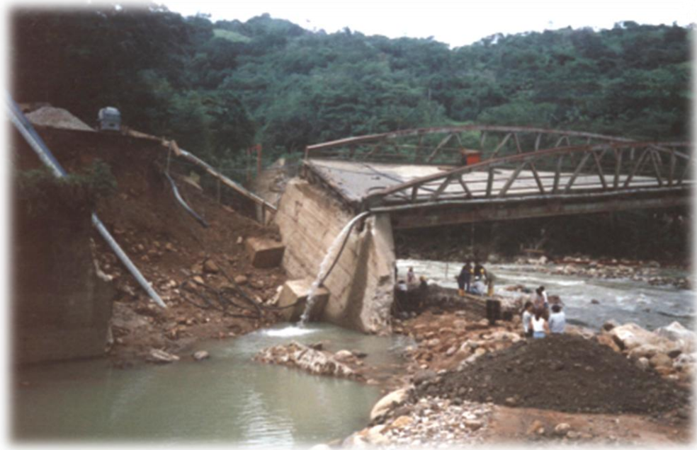
Figura 1.1 Fallo del estribo del puente Unete (Colombia) por socavación
