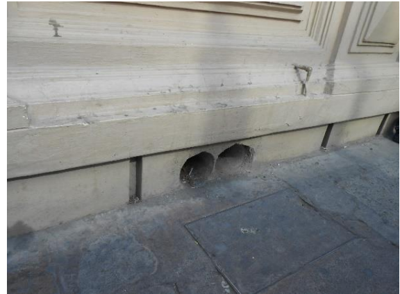
Ilustración 29. Descarga de la red pluvial.
