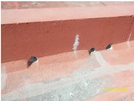
Ilustración 9. Perforaciones en la trabe.
