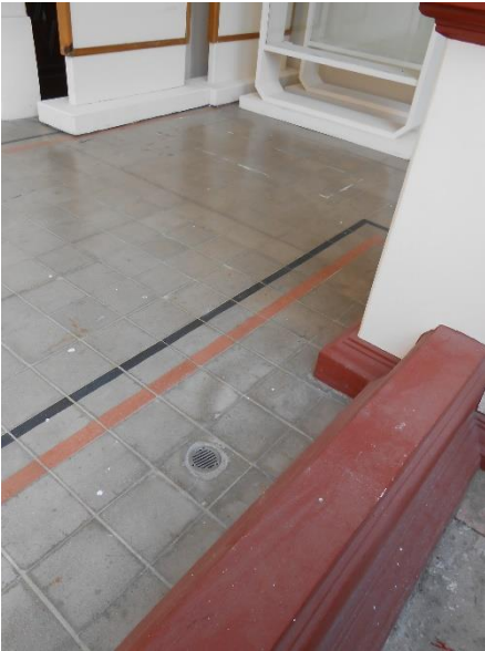
Ilustración 19. Coladera de pasillo.
