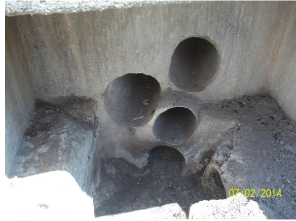
Ilustración 27. Tuberías en el registro No. 5.
