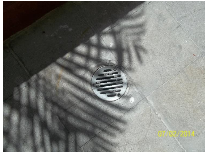
Ilustración 7. Coladera de pasillo.
