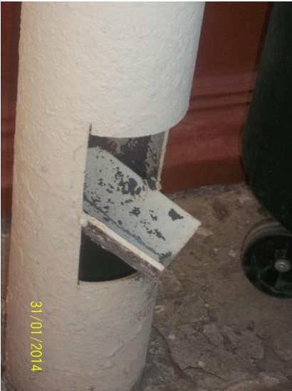
Ilustración 5. Corte en la tubería de bajada.
