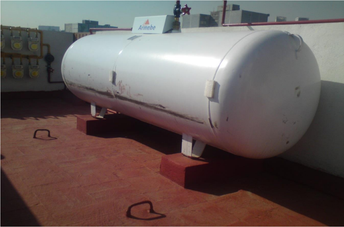
Foto 31. Tanque de gas y medidores en azotea.
