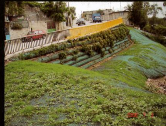
DESPUÉS: muro con cara vegetada que soporta la vialidad; sistema de mallas protege contra erosión
