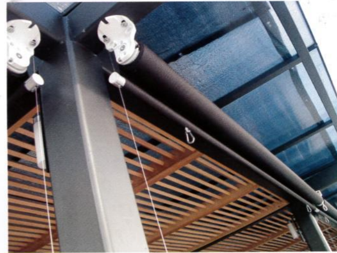
Brackets y sistema de cables tensores.
