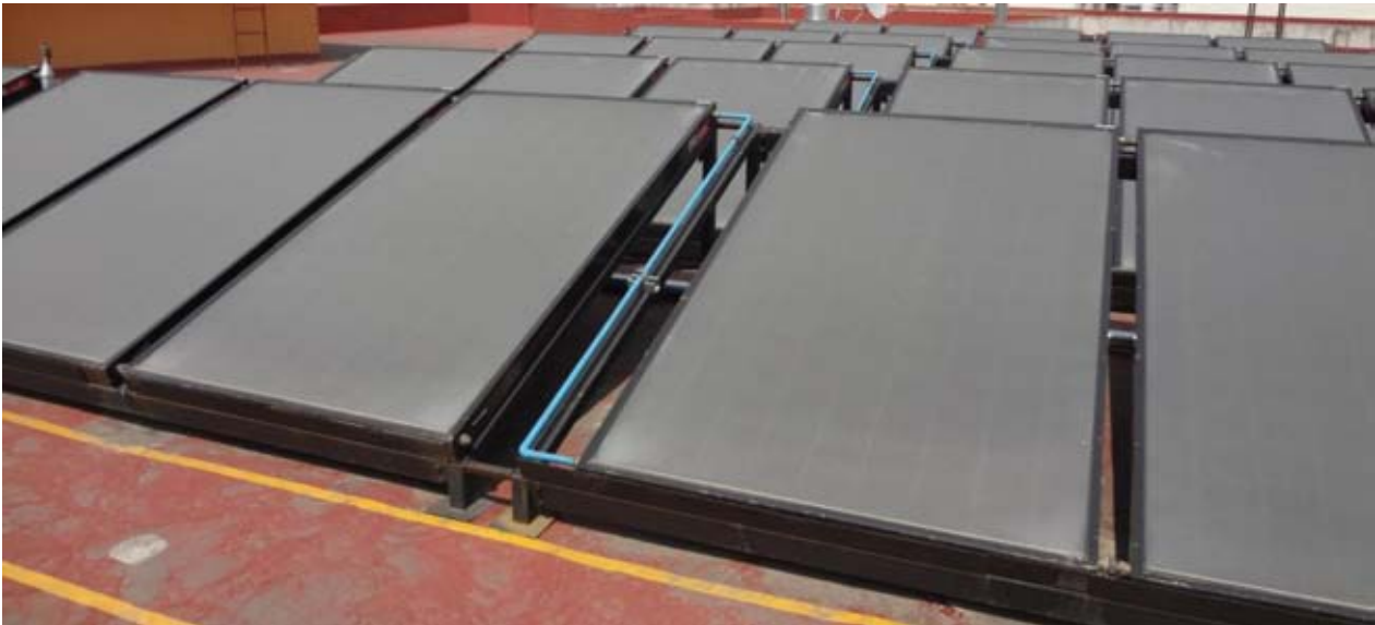
Figura 29. Imágenes del campo de colectores. Toma frontal.
