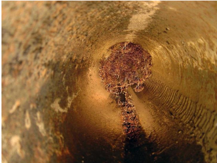
Figura 2.8. Obstrucción por raíces de un sistema de alcantarillado
