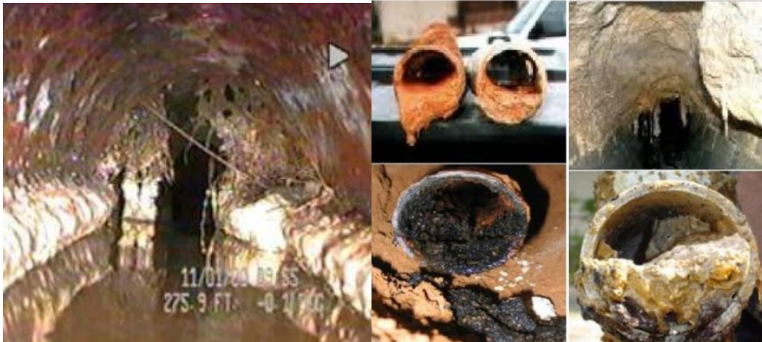
Figura 2.16. Grasa en el alcantarillado
