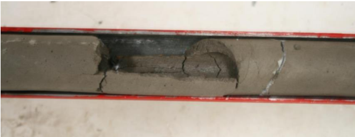
Figura 4.12. Vista en planta de la falla del tubo
