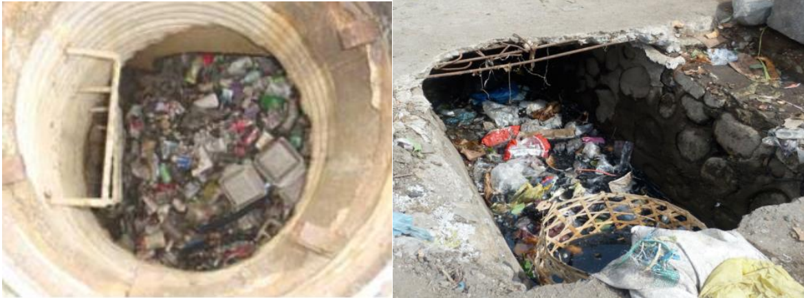
Figura 2.17. Basura en el alcantarillado
