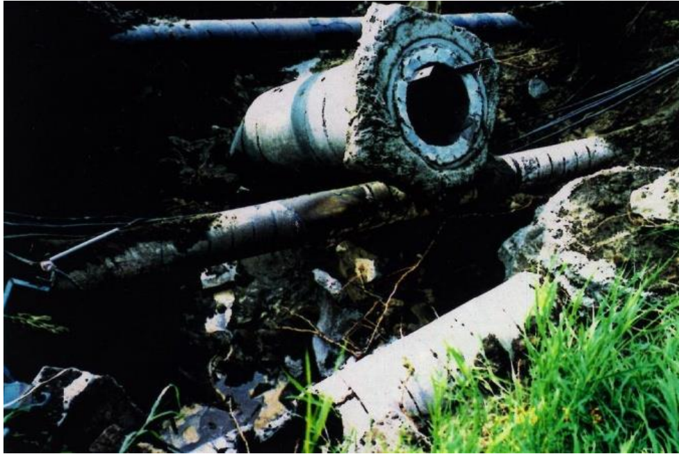
Figura 4.16. Ruptura de la Infraestructura del drenaje de la Ciudad de Edmonton, Canadá
