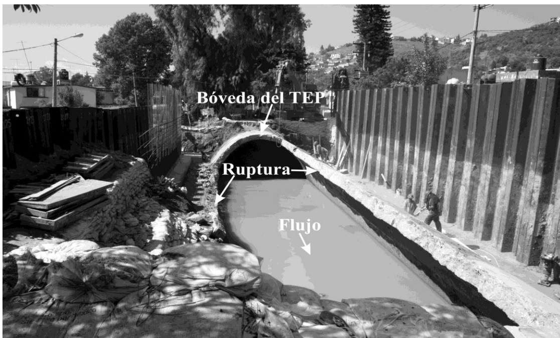
Figura 4.1. Ruptura del Túnel Emisor Poniente
