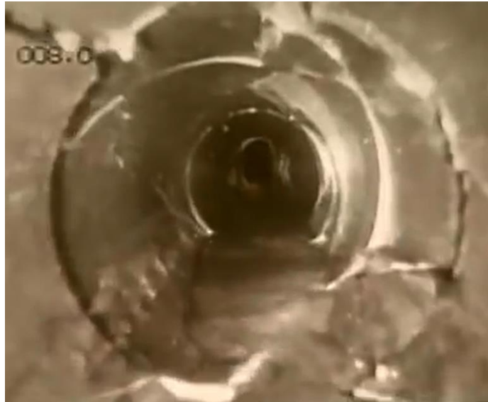
Figura 3.11. Inspección con cámara de una tubería de drenaje con fracturas
