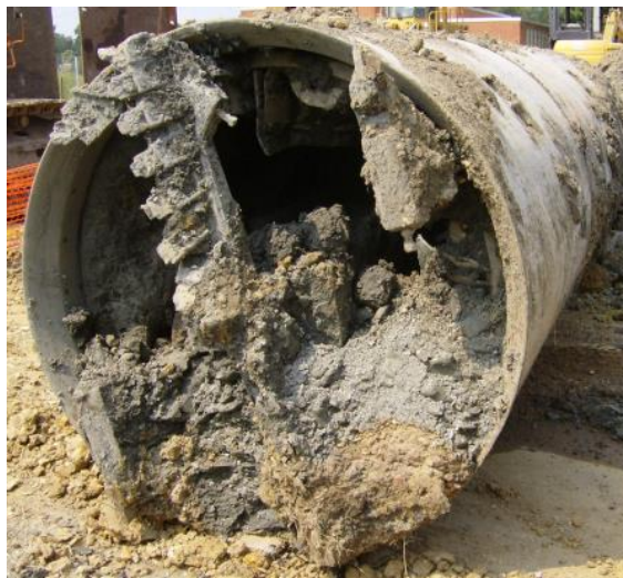
Figura 2.18. Arenas y piedras en el alcantarillado
