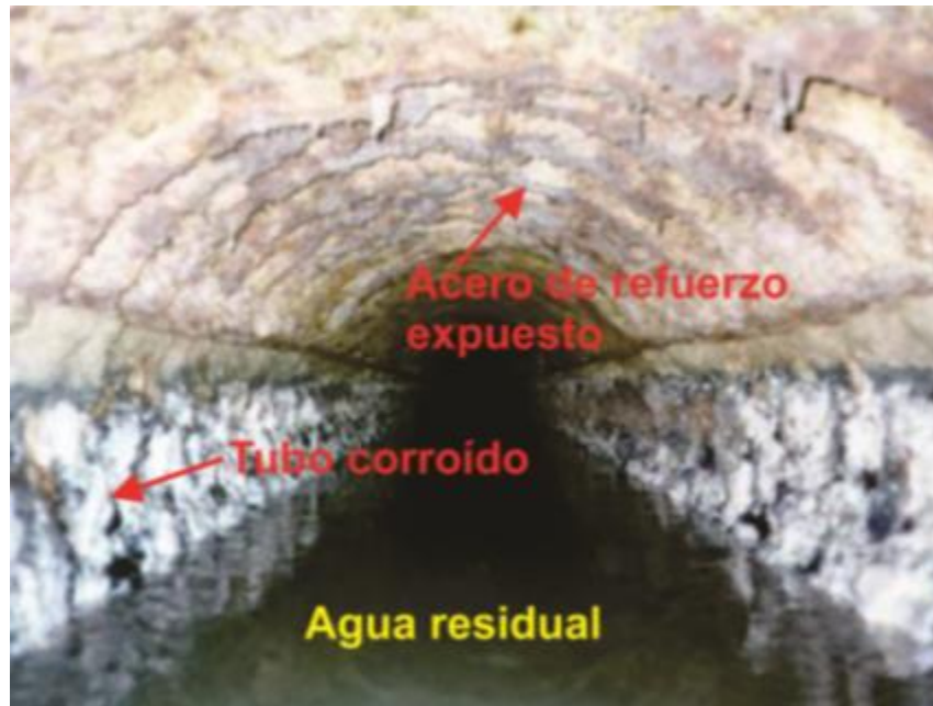
Figura 2.5. Tubería de concreto corroída con el acero de refuerzo expuesto (Basurto et al. 2012)
