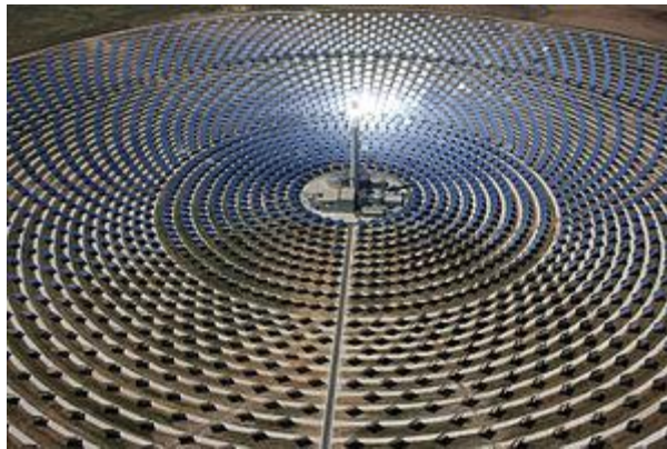
3 Ejemplo Concentrador estacionario, planta termoeléctrica Gemasolar (Andalucía, España)
