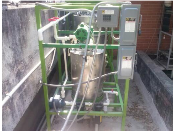
Figura 3.7 Instalación de bombas, moto reductores y registros
