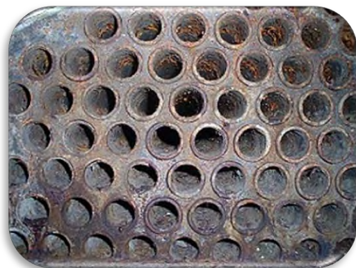
Figura 2.10 Incrustaciones en interior de banco de tubos de un intercambiador de tubos y coraza
