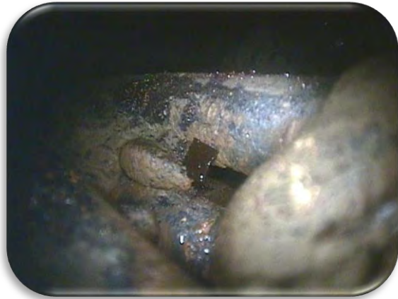
Figura 2.9 Ensuciamiento en parte exterior de tubos de intercambiador de calor
