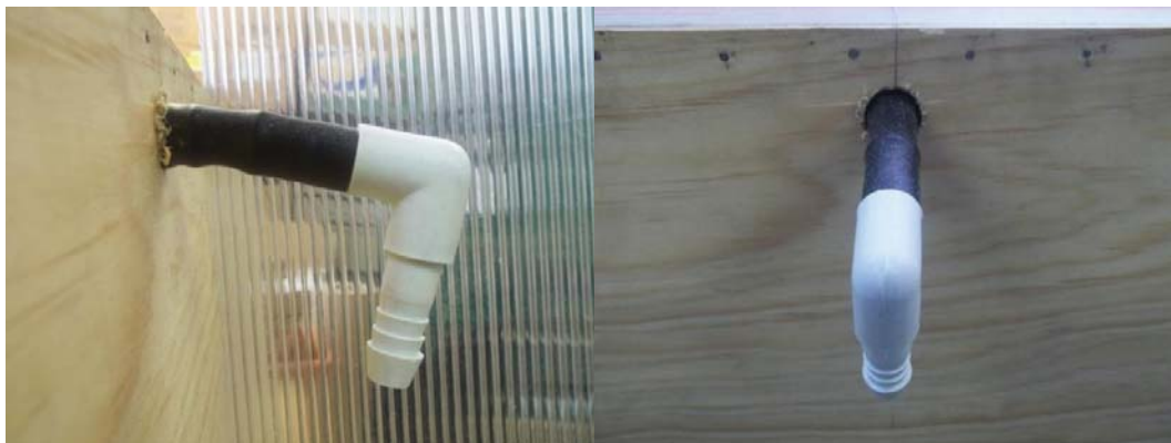
Figura 3. Conexión para el suministro del agua de riego a ambos paneles.
