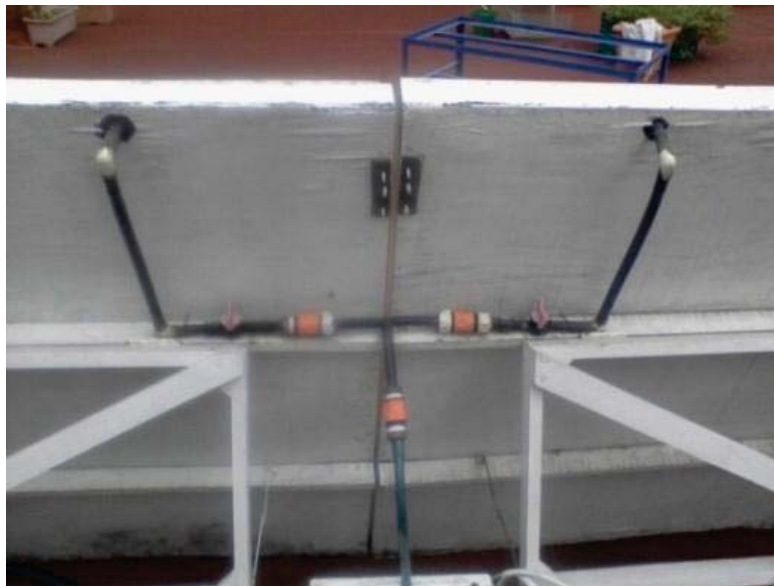
Figura 23. (a) Vista de la conexión en "Y" para el suministro del agua de riego a ambos paneles.
