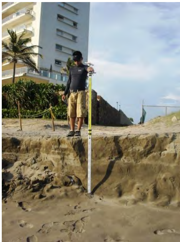
Figura 40. Estación de campo N° 6, Hotel Playa Mar – Tres Vidas. Fotografía tomada el 14/09/2012. Se muestra la altura del escarpe erosivo registrado en la estación.
