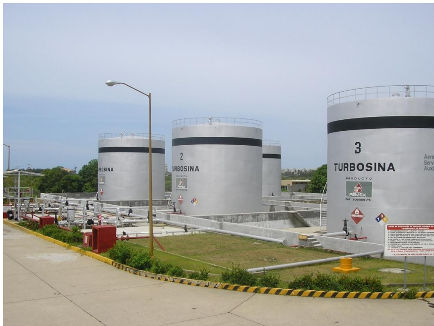
Tanques de almacenamiento de combustibles
