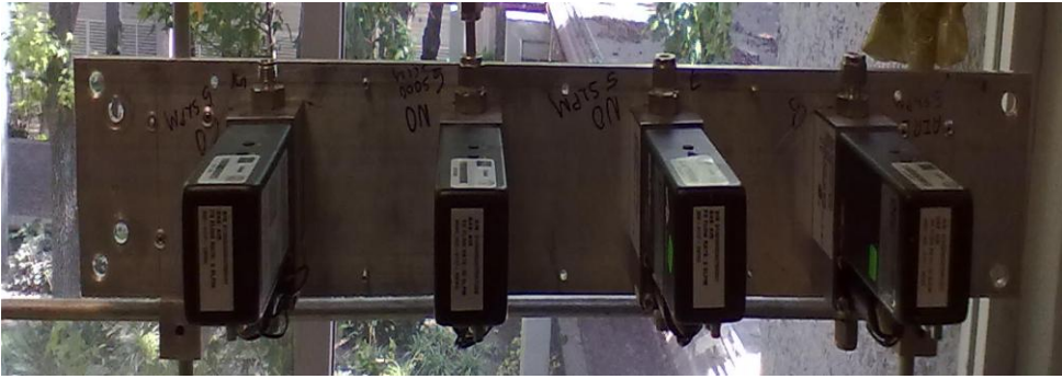
Figura 17. Controladores de flujo másico.
