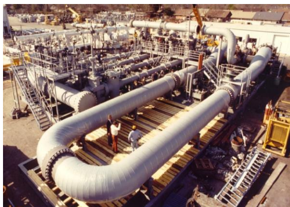
Figura 5 2b Instalación del probador bidireccional para calibración.
