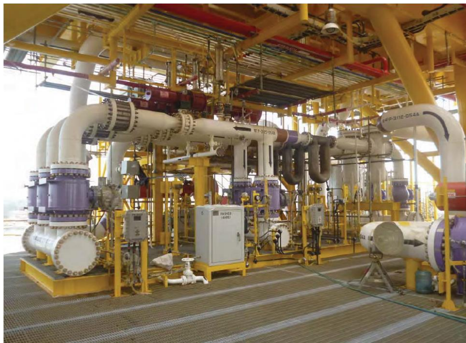
Fig. 6.6 b. Sistema de medición instalado
