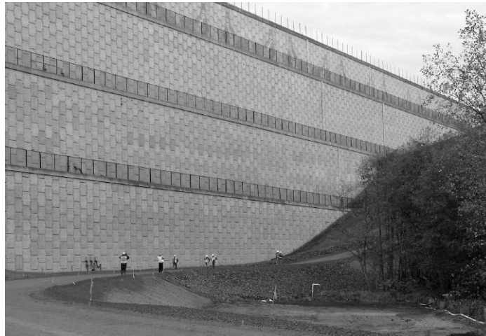
Fig. 5.3 Muro de Tierra Armada de 42 m de altura, Aeropuerto de Seattle, USA
