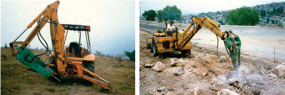
Figura 5.11b – EMPLEO DE DOS MARTILLOS ROMPEROCA (Marca MONTABERT BRH-125 y BRH-250) MONTADOS SOBRE 2 CARGADORAS-RETROEXCAVADORAS que permitieron un trabajo rápido y económico de excavación en tepetate duro y roca.
