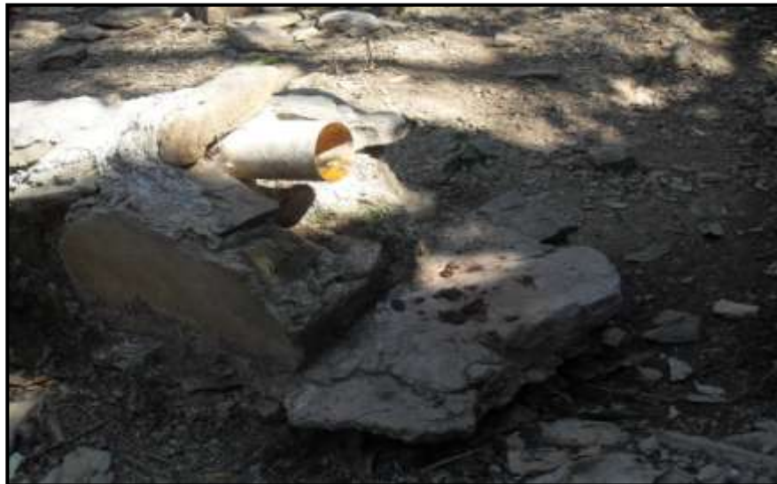
Figura 14. Fotografía que muestra la salida del “drenaje” de una casa habitación hacia la calle. San Martín Pachivia, Guerrero, México, 2010.
