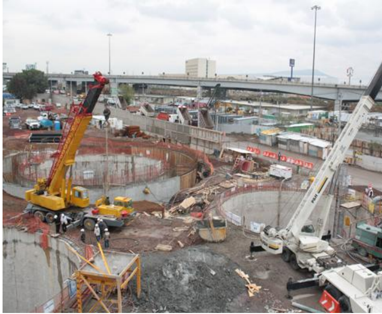
Imagen 3. 31 Construcción de la Planta de Bombeo el Caracol, para apoyar el tramo I en su función
