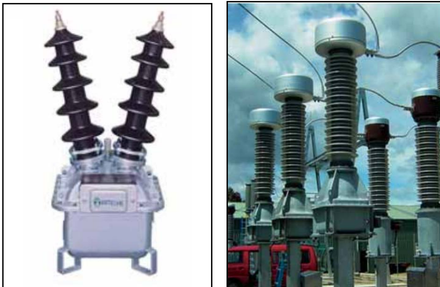
Figura 10. Transformadores de potencial tipo inductivo.
